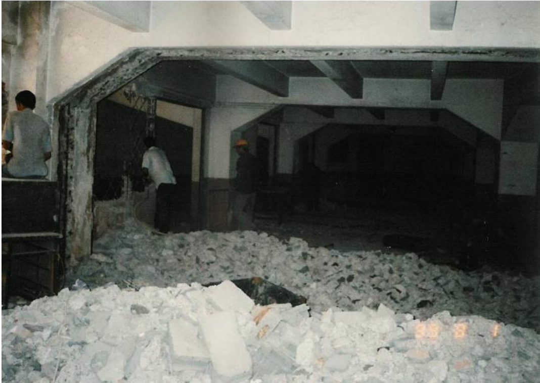
Şekil 4.1.21 Eski Halı ve Manifatura Antreposu No: 13 ( şimdiki Ticaret Odası) restorasyonda kırılan döşemelerde, hasır donatılı betonarme döşemeler açığa çıkmıştır. (Ticaret Odası restorasyonundan, İTO arşivi)
