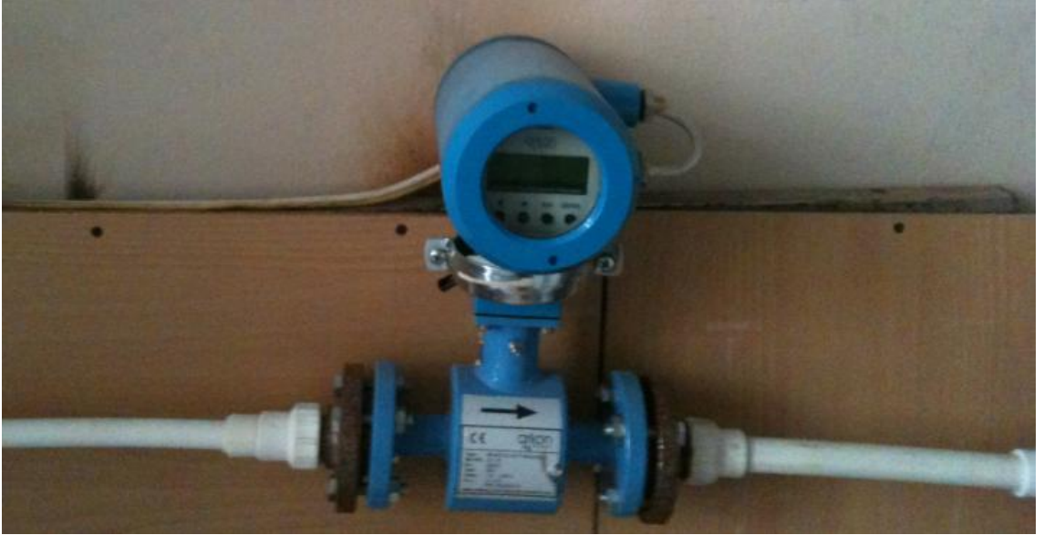
Şekil 4. 13 Duvar üzerine monte edilen panoya bağlanmış debimetre
