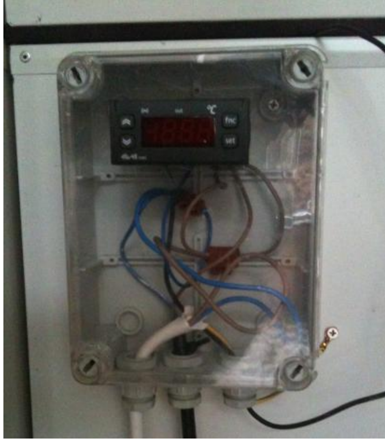
Şekil 4. 14 Sıcak su banyosu üzerinde yer alan suyun sıcaklığını düzenleyen cihaz
