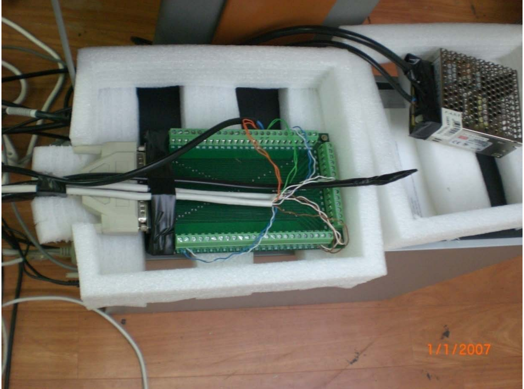
Şekil 2.7 Hareket kontrol kartının dağıtıcısı ve 5 volt güç kaynağı
