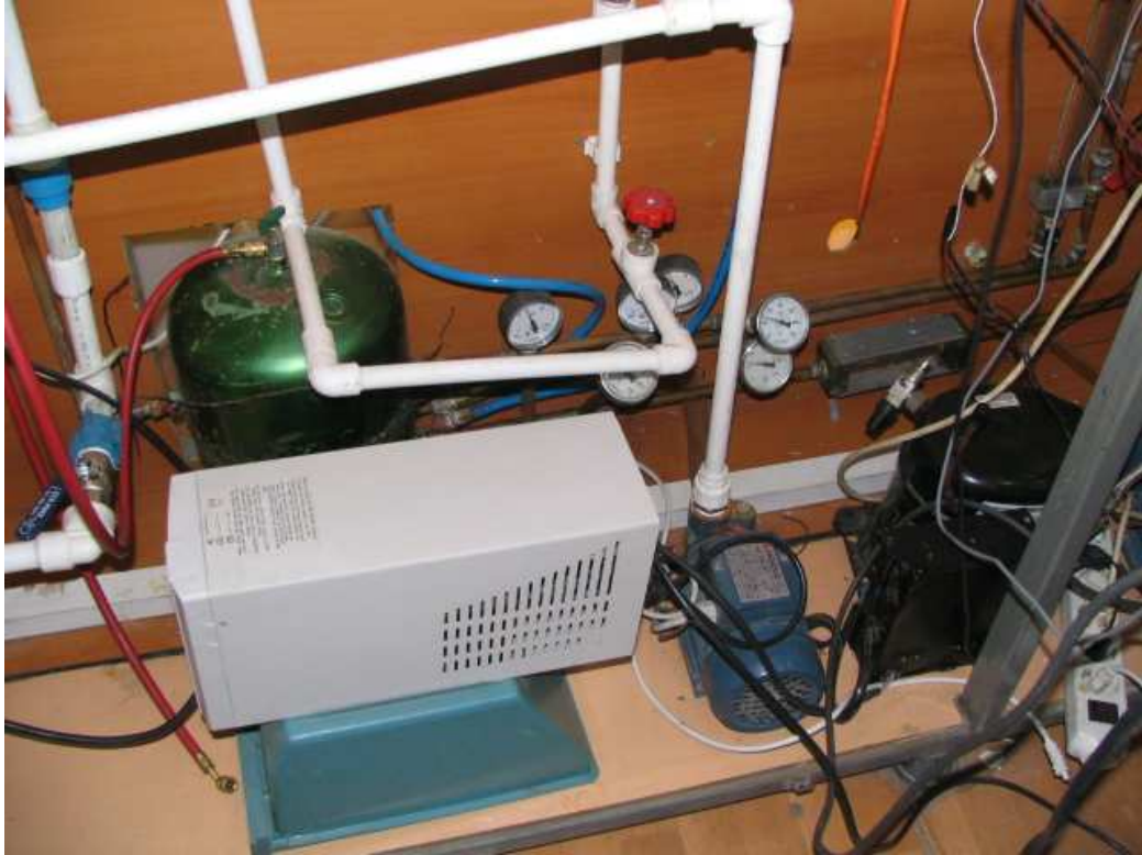
Şekil 4.13 Deney tesisatında kullanılan güç kaynağı ve R134a deposu
