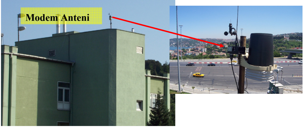
Şekil 5.3 RTK-GPS verici modem anteni
