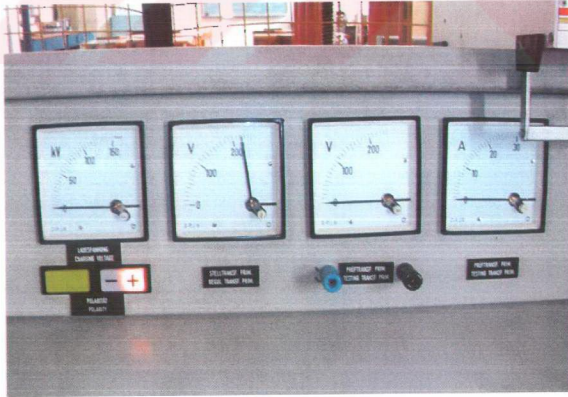
Şekil Ek 1.15 Kumanda masasında yer alan ölçü ampermetre ve voltmetreleri
