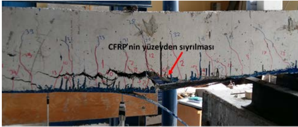
Şekil 4. 33 K40KG00 deney kirişinin göçme mekanizması
