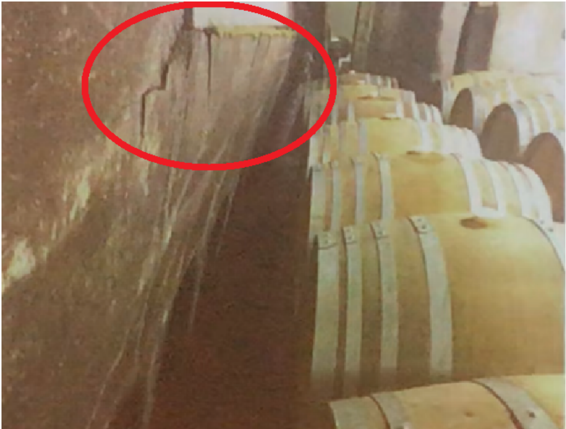
Şekil 2.3 İlk gözlenen krip, Cienega Şaraphanesinin duvarında meydana gelmiştir [56]
