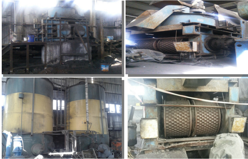
Şekil 4. 12 Milten Müteahhitlik briketleme tesisi ekipmanları
