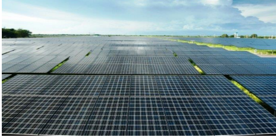
Şekil 3.28 Olmedilla - İspanya fotovoltaiik enerji tesisi
