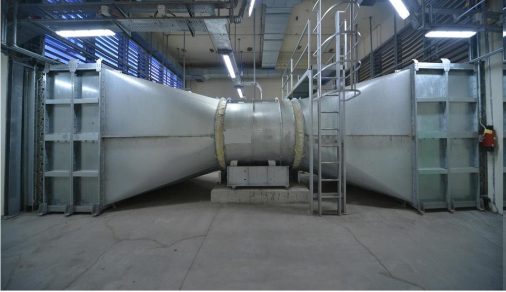
Şekil 2.3 Tünel havalandırma fanı (TVF)
