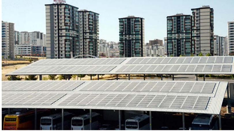
Şekil 3.16 DİŞTİ çatı üzeri güneş paneli uygulaması
