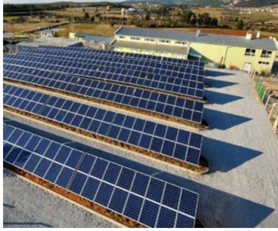
Şekil 3.22 Muğla Belediyesi Mezbağa Tesisi GES
