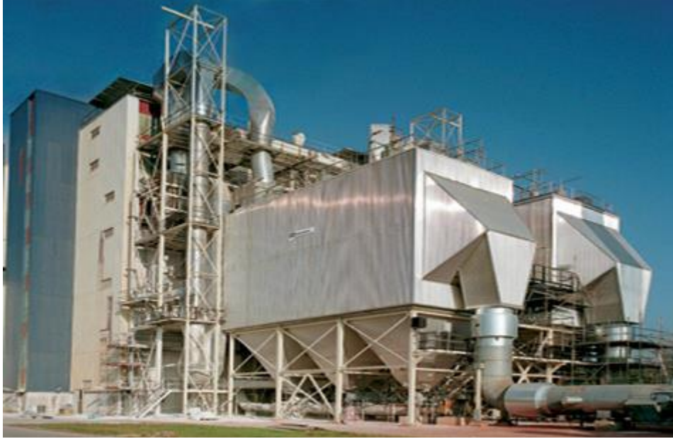
Şekil 5.29 Bir termik santralde elektrofiltre tesisi [22]
