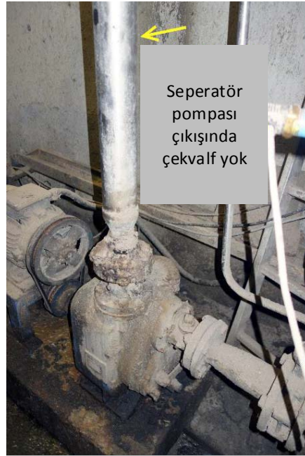
Şekil 6. 26 Keçe tahliye pompası dizayn hatası
