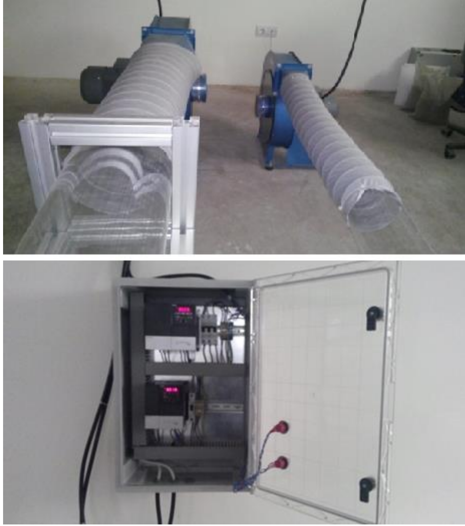
Şekil 4.4 Hava fanları (üstte) ve frekans kontrol panosu (altta) [12]
