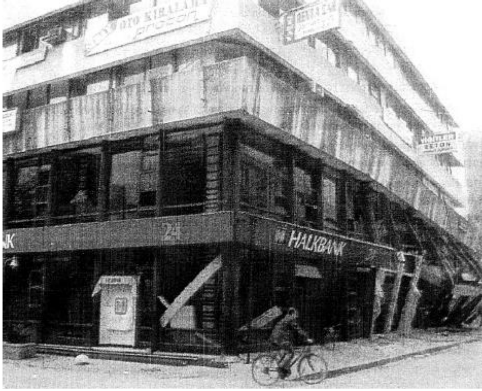
Şekil 2. 2 Düzce depreminde burulma titreşimine maruz kalmış hasarlı bir bina
