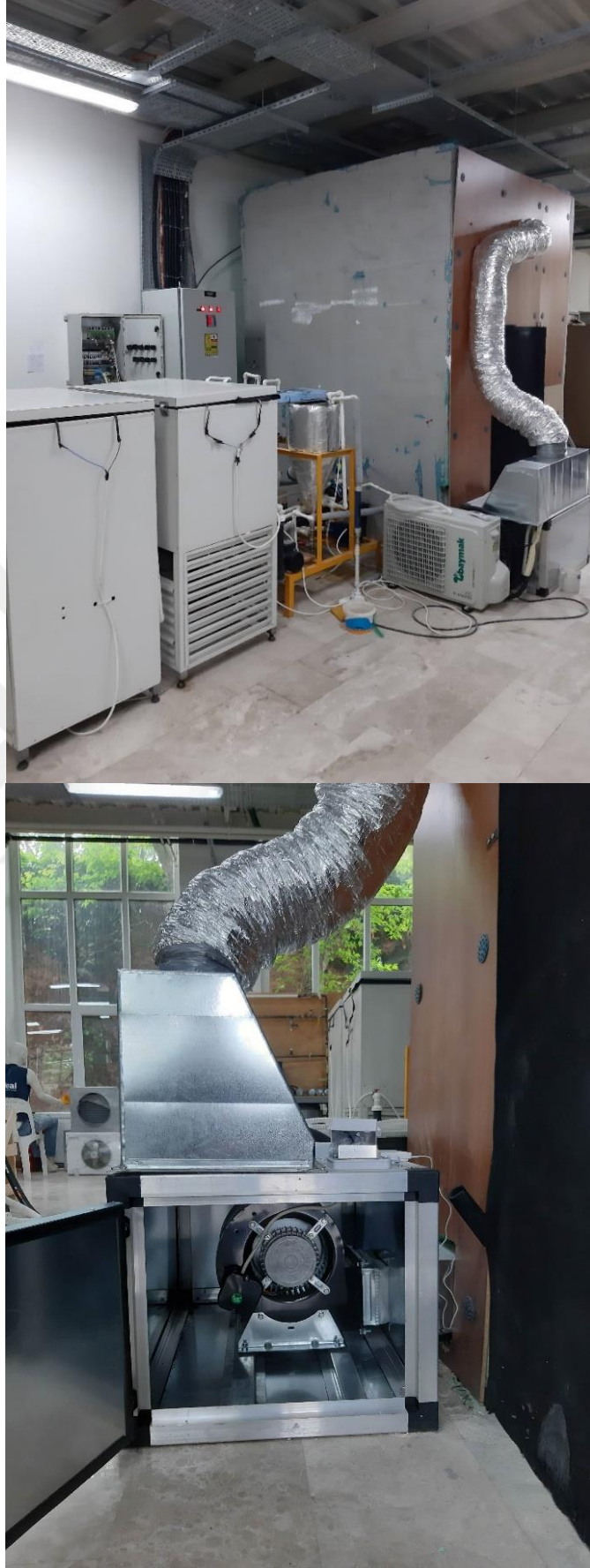
Şekil 3.3 Havalandırma dış ekipmanlar (özel yapım klima santrali, egzoz kanalı)
