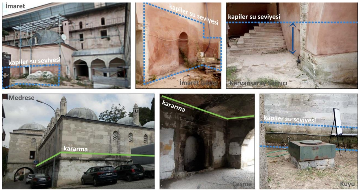
Şekil 4. 13 Atik Valide Sultan Külliyesi'ndeki su ile bağlantılı hasar göstergeleri. Çizim kaynağı: [168]
