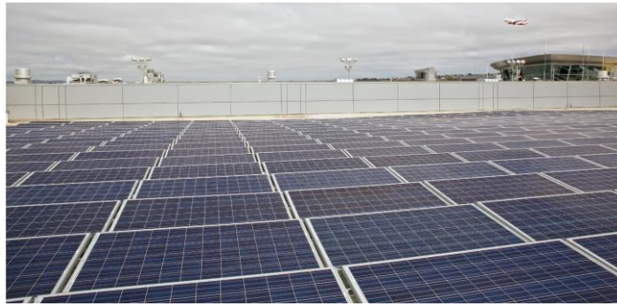
Şekil 3.29 San Diego Havalimanı otopark çatısına kurulu güneş enerji santrali [121].
