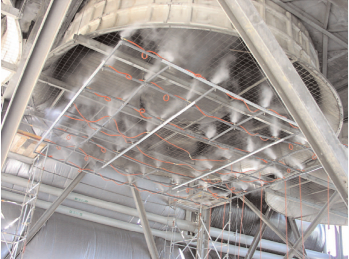
Şekil 3.9 Hava Soğutmalı Kondenser Sprayleme Sistemi [24]
