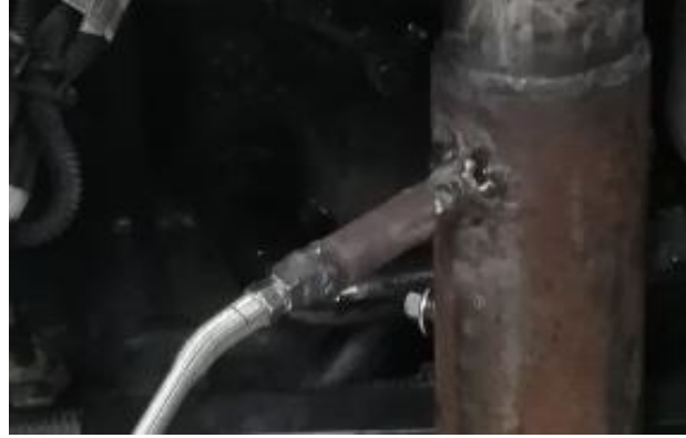
Şekil 5.20 Motor soğutma suyu giriş çıkış sıcaklık ölçüm yeri
