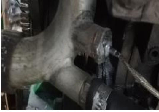
Şekil 5.19 Motor soğutma suyu giriş çıkış sıcaklık ölçüm yeri
