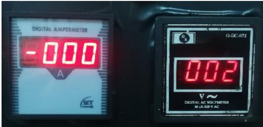
Şekil 5.22 Voltmetre ve ampermetre
