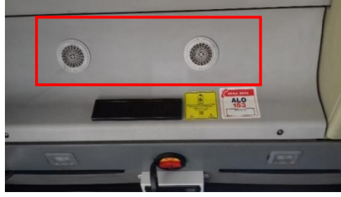
Şekil 3.19 İETT ek üfleme menfezleri kapı bölgesi
