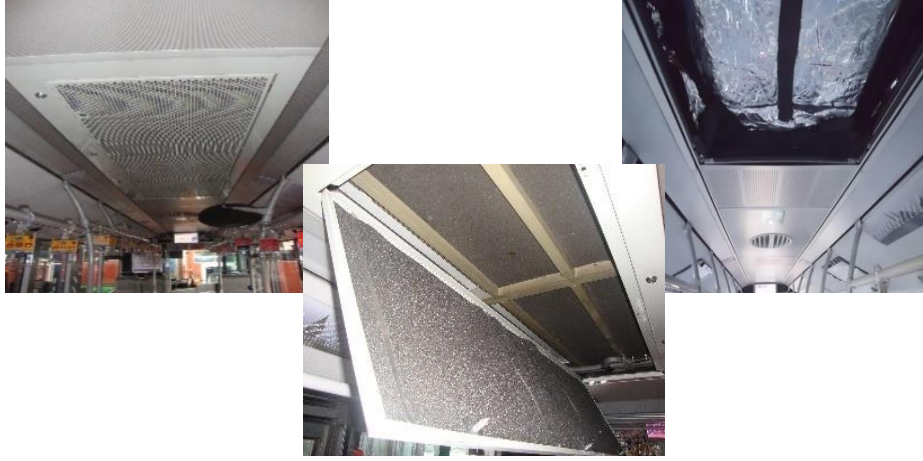
Şekil 3.14 İETT hava emiş bölgesi
