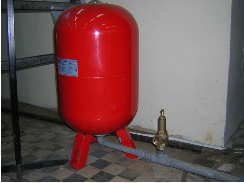
Şekil 3.11 Kapalı genleşme tankının fotoğrafı
