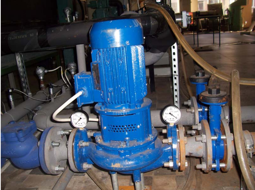
Şekil 3.9 Kondenser soğutma suyu pompasının fotoğrafı
