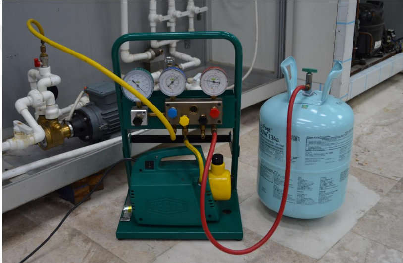
Şekil 3.12 Soğutucu akışkan vakum pompası ve şarj istasyonu
