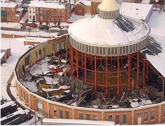
Şekil 4. 12 B&O Ulaşım Müzesi. Çatının çökmesi, 2003 [67].
