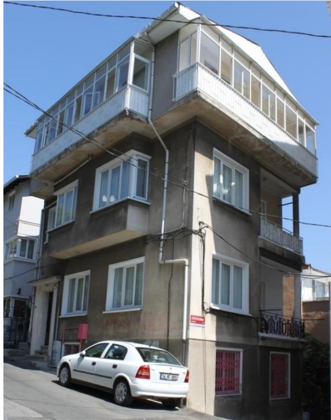
Şekil 5.8 Taşıyıcı sistem ve cephe bütünlüğünde bozulmalara neden olan kat eklemeleri
