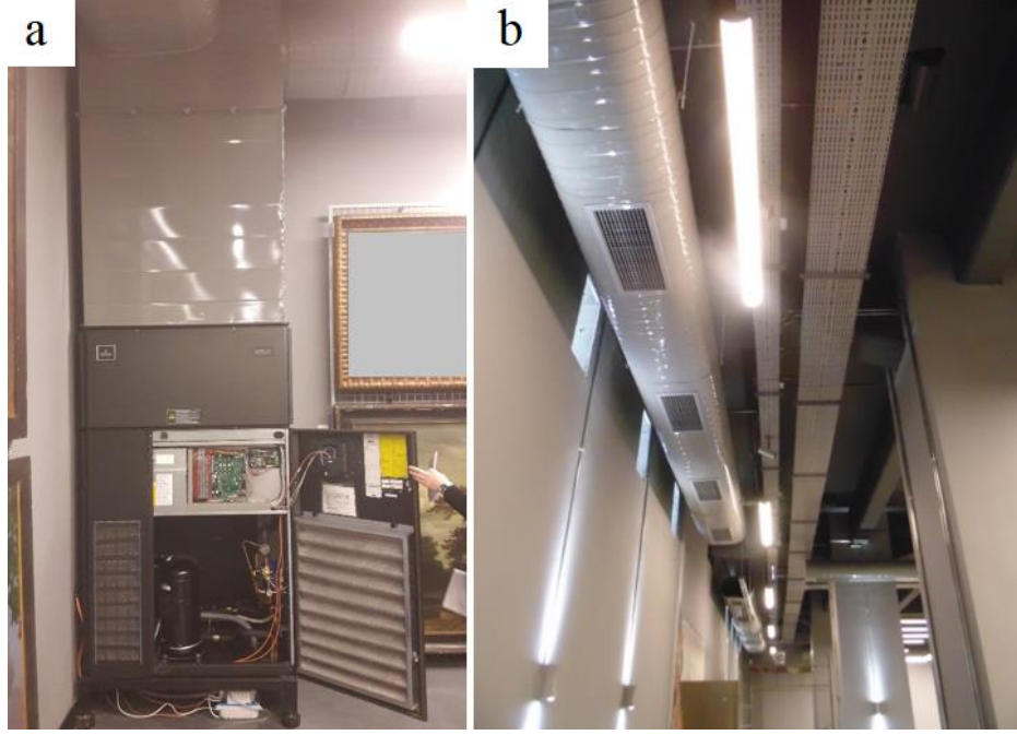
Resim 27: a) Resim deposunda bulunan iklim denetim ünitesi, b) havalandırma kanalları
