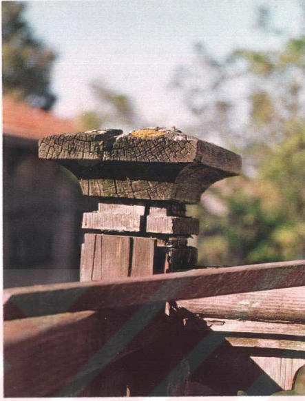
Şekil 31. Örneklerin alındığı Büyükkada'daki ahşap ev'den ayrıntı, mantarla bozularak kare şeklinde çatlaklar oluşmuş balkon korkuluğu babası
