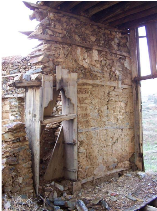
Resim 23.6. Yıkılmış Taş Duvar İçindeki Dolap Detayı
