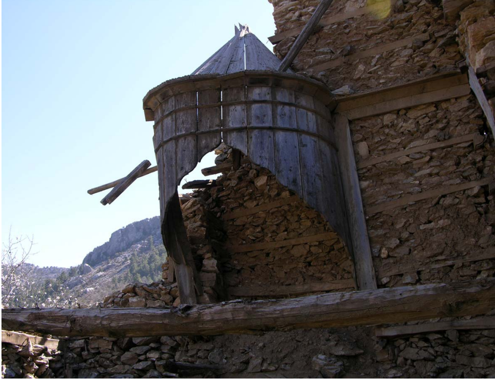
Şekil 4.68 Yıkılmış bir yapının davlumbazı
