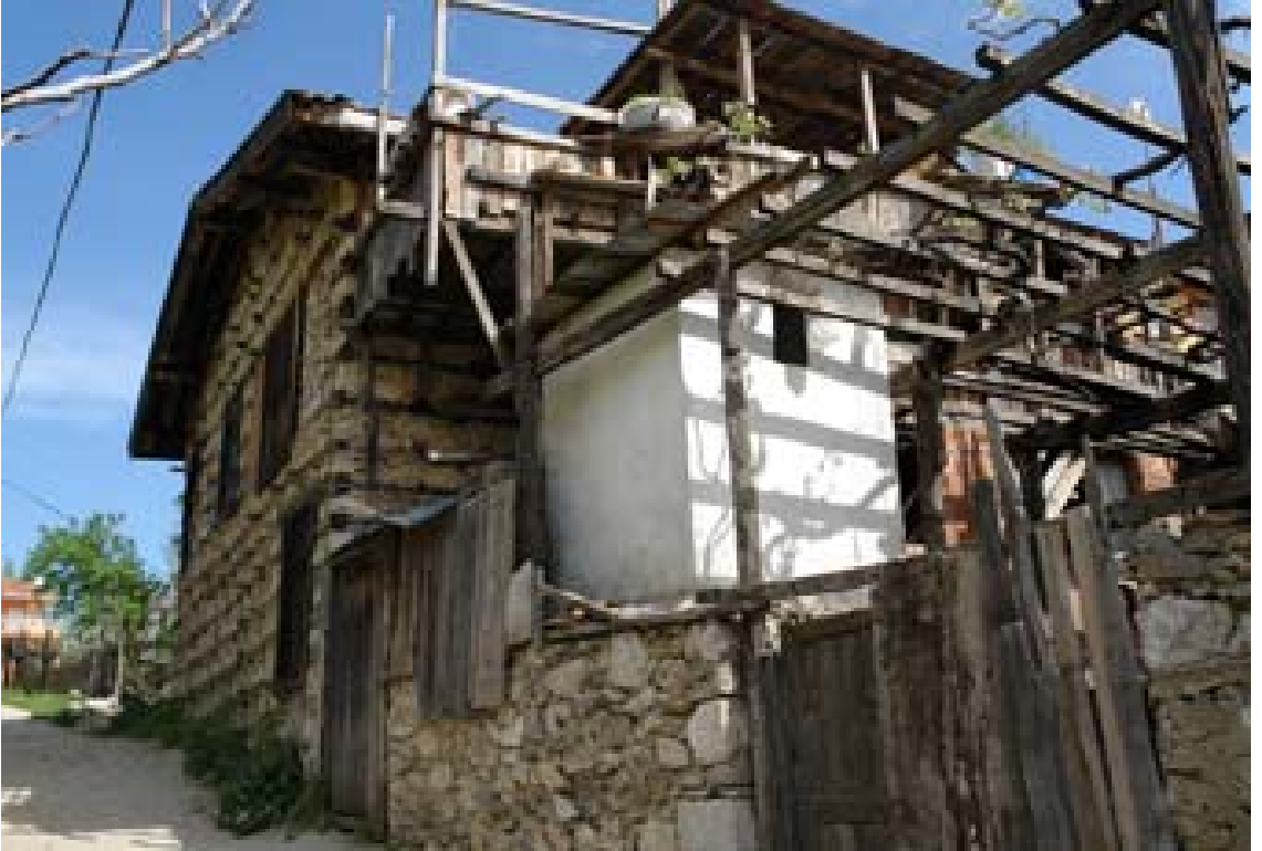
Şekil 6.40 Giriş cephesine yapılan muhdes ekler
