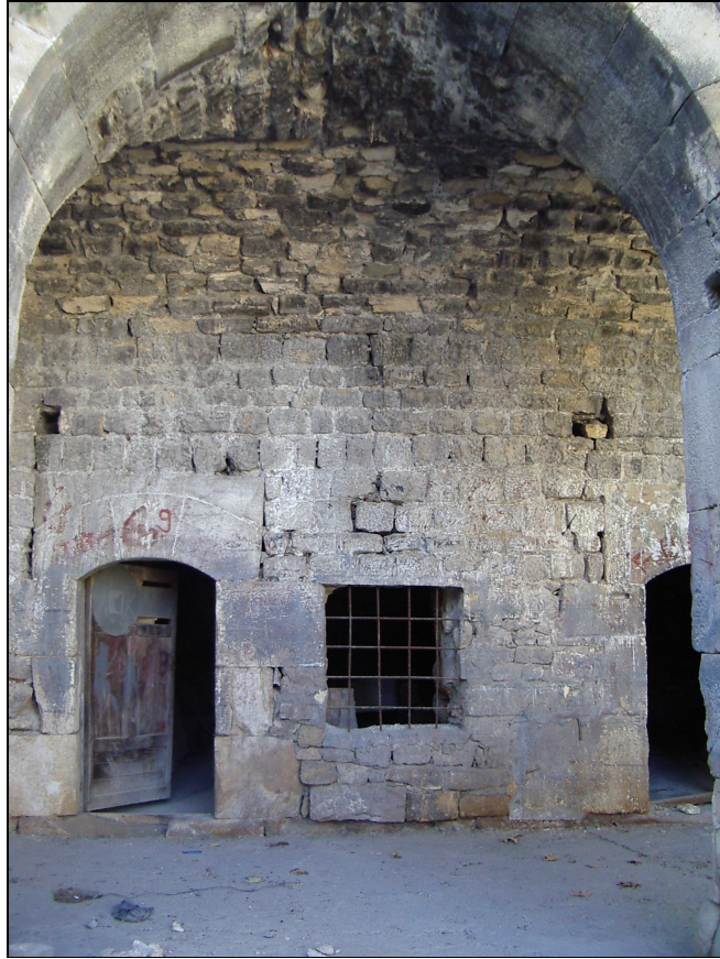
Şekil 30 Oda duvarında açılmış muhdes pencere boşluğu
