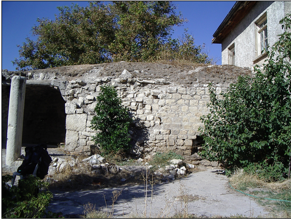
Şekil 36 Katırlığın yıkılması sonucunda oda dış duvarlarında oluşan hasarlar
