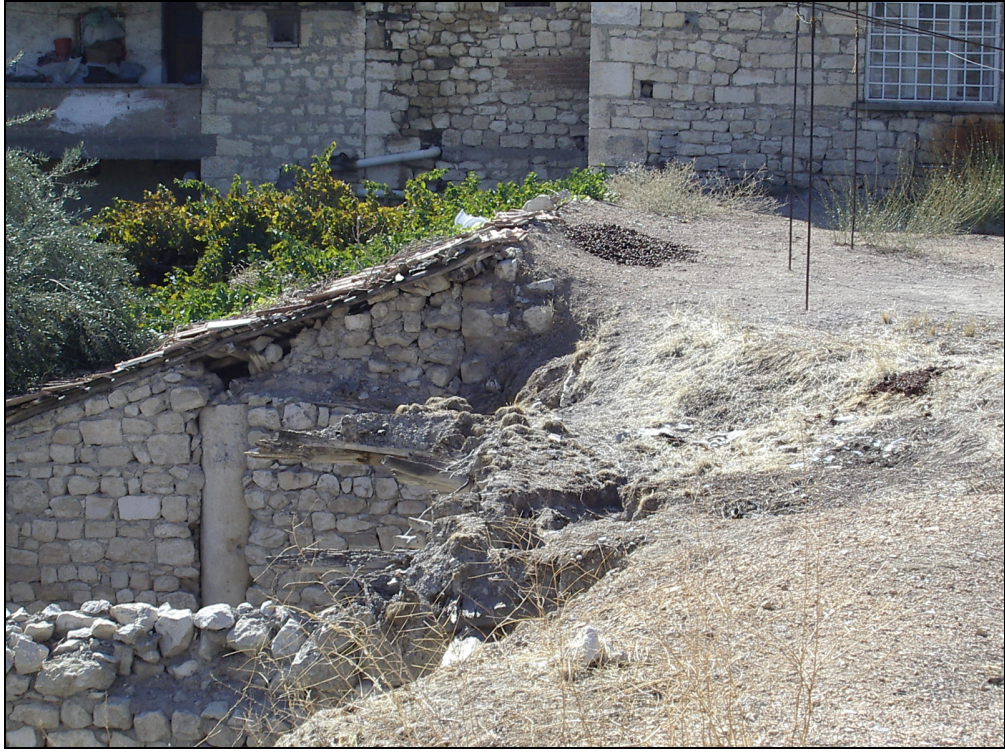
Şekil 37 Katırlığın yıkılması sonucunda oda tavanlarında oluşan hasarlar
