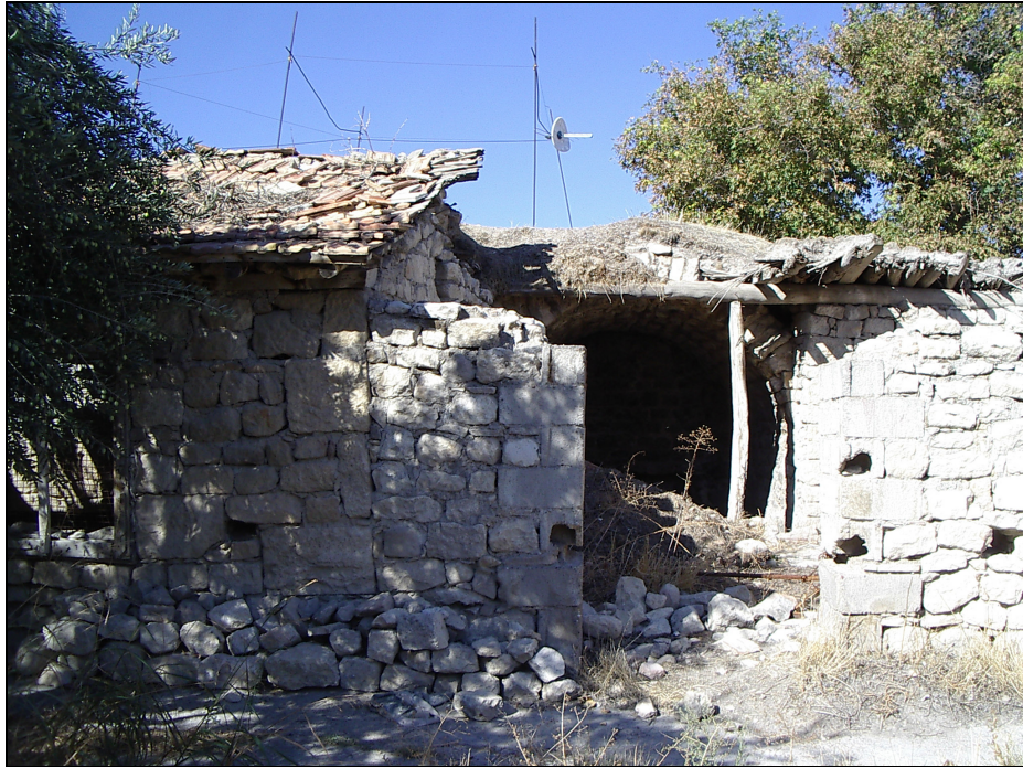
Şekil 14 Hanın katırlığa bitişik olan duvarında, yıkılmalar ve muhdes yapılar
