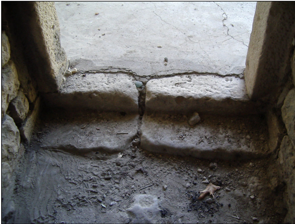
Şekil 43 Özgün taş eşik ve döşeme kaplaması kalıntısı
