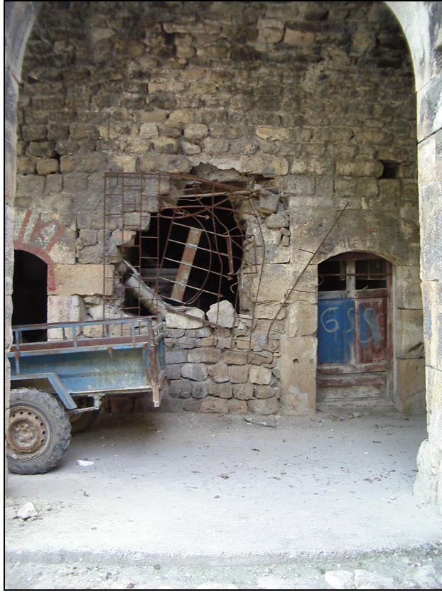
Şekil 31 Oda duvarında açılmış muhdes pencere boşluğu
