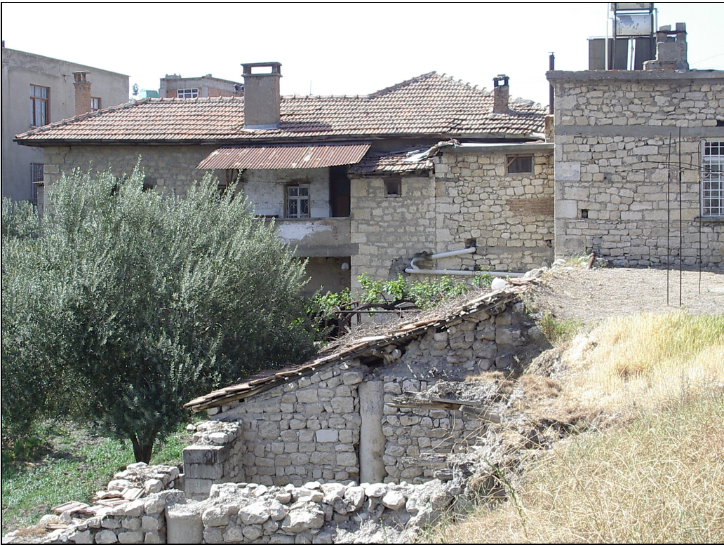
Şekil 34 Katırlık bölümünde yer alan muhdes yapılar
