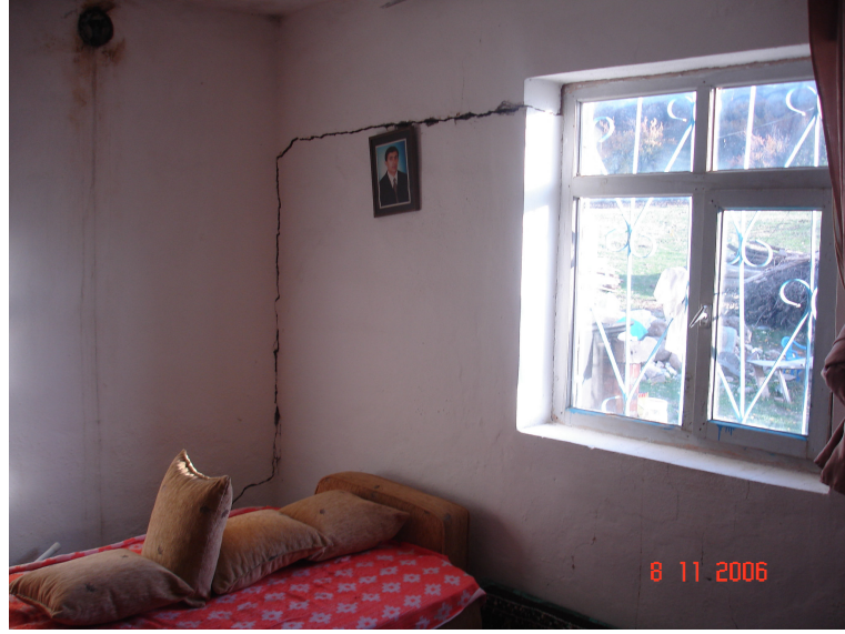
Şekil 4.36 20 cmlik dış duvarlar ve depremde oluşmuş çatlaklar
