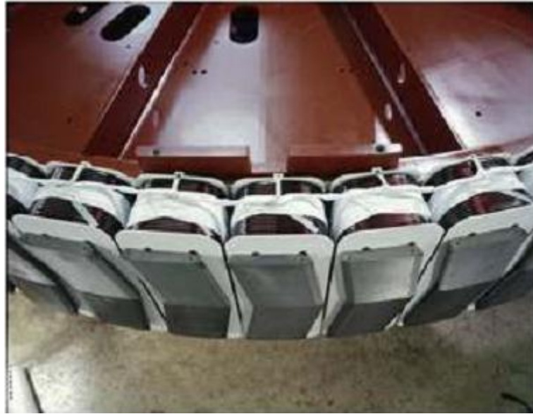
Şekil 3.4 Direct Drive sistemli Enercon jeneratör
