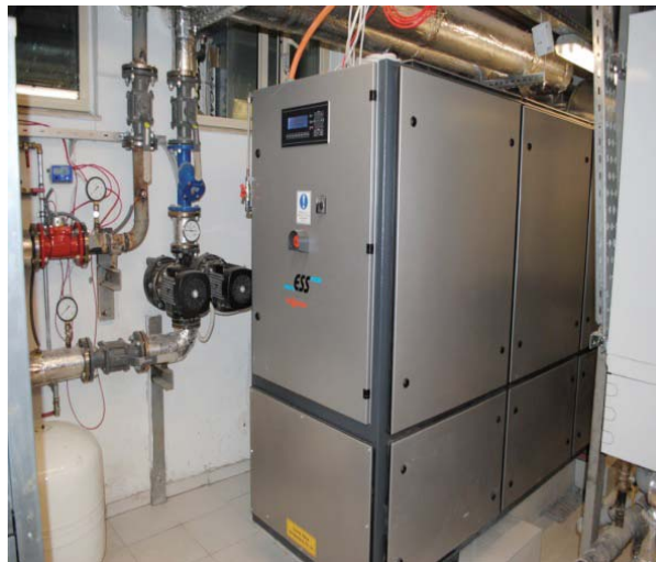
Şekil 5.8 Isı Pompası Görünümü [78].
