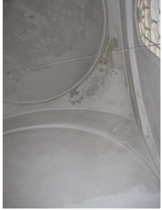
Şekil 5.116 Z-11 nolu odada sıvada kabarma, 2010
