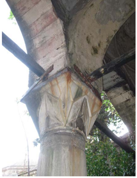
Şekil 3.64 Metal elemanlarda korozyon, 2010
