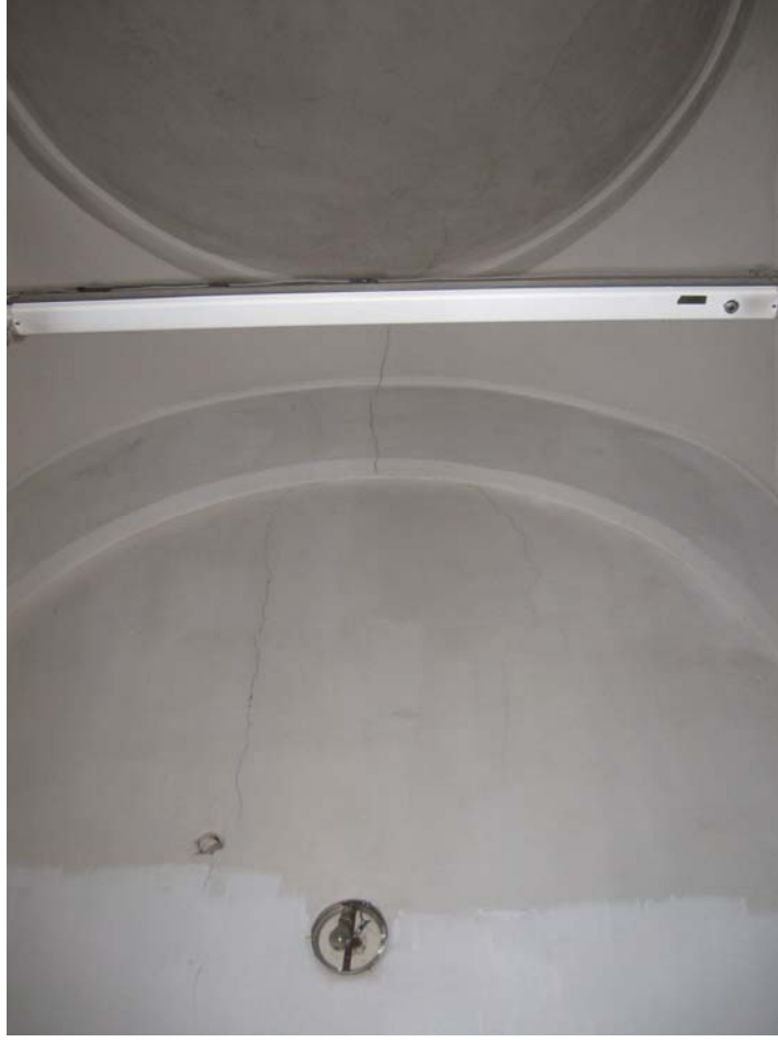
Şekil 5.101 Z-09 nolu odadaki çatlak, 2010
