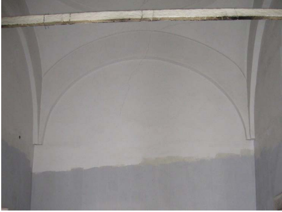
Şekil 5.105 Z-16 nolu odadaki çatlak, 2010
