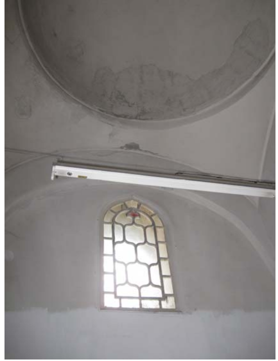
Şekil 5.118 Z-09 nolu odada sıvada kabarma, 2010
