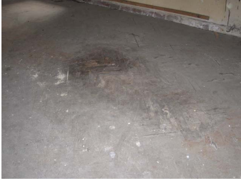
Şekil 5.119 Z-06 nolu odada döşemede kabarma, 2010
