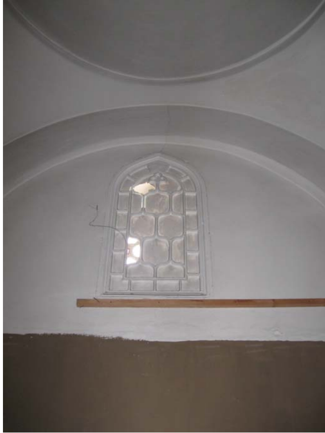
Şekil 5.104 Z-18 nolu odadaki çatlak, 2010
