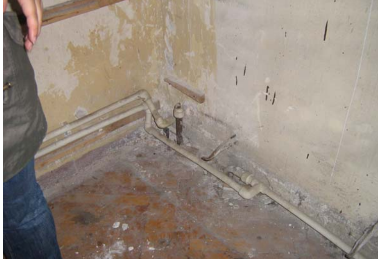
Şekil 5.128 Duvar yüzeyinde tahribat, 2010
