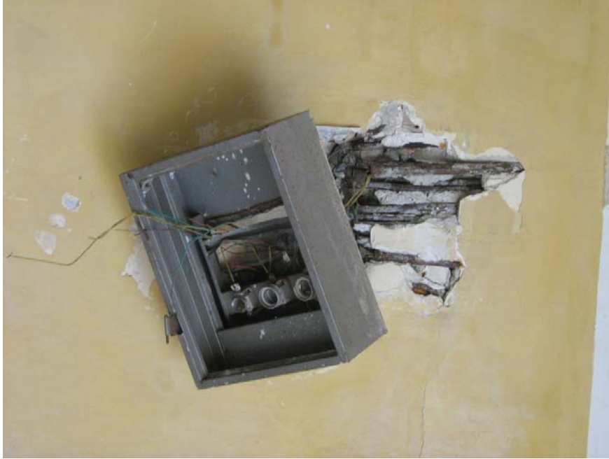
Şekil 5.127 Sağlıksız elektrik tesisatı, 2010
