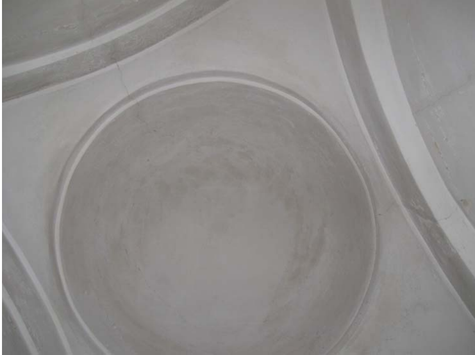
Şekil 5.102 Z-12 nolu odadaki çatlak, 2010
