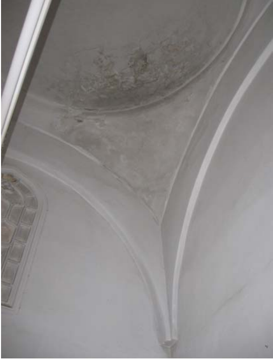
Şekil 5.115 Z-10 nolu odada sıvada kabarma, 2010
