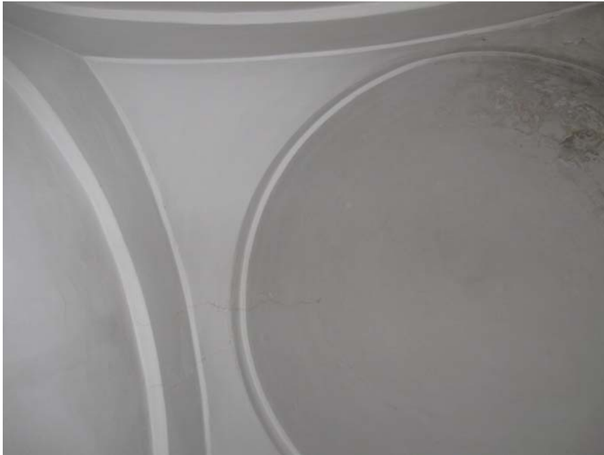
Şekil 5.100 Z-10 nolu odadaki çatlak, 2010
