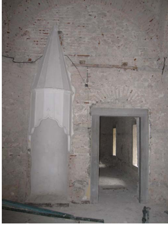
Şekil 7.5 İç duvarlarda çimento sıva raspası, 2010
