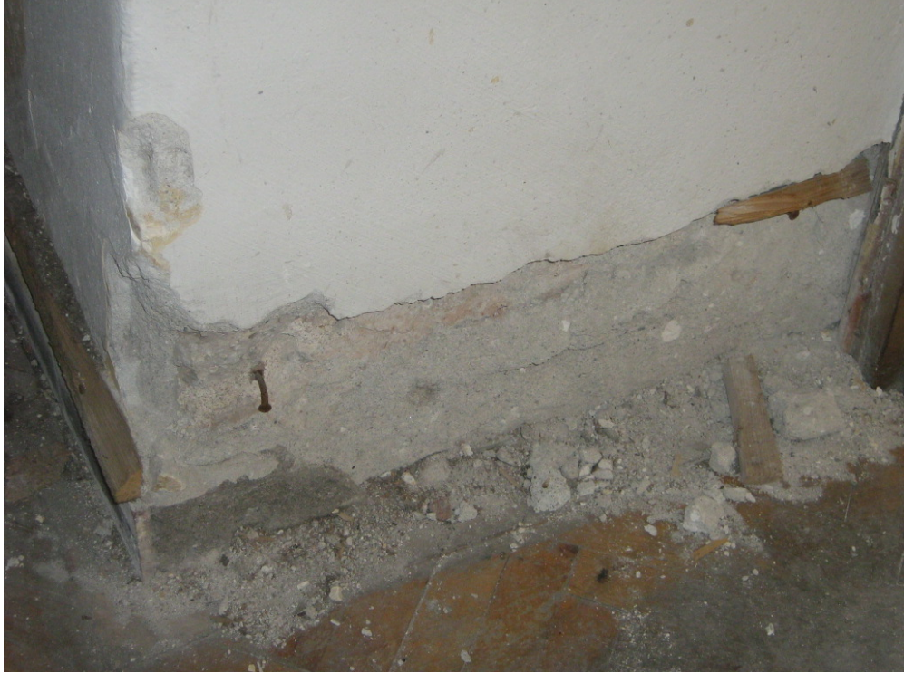
Şekil 5.124 Duvar yüzeyinde kopma, 2010
