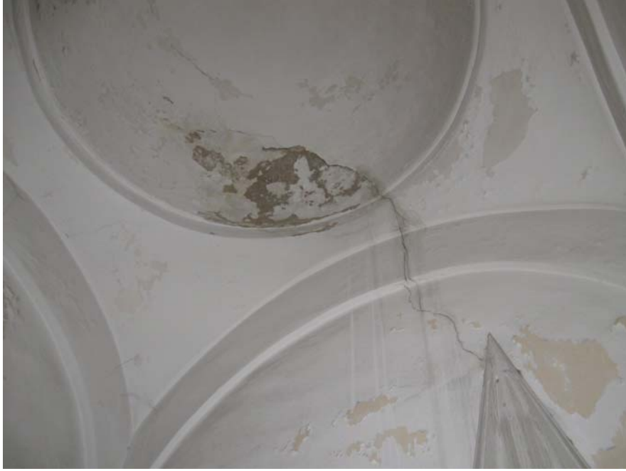
Şekil 5.99 Z-13 nolu odadaki çatlak, 2010
