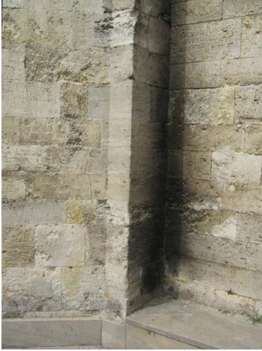
Şekil 5.113 Taş yüzeyde bozulma, 2010
