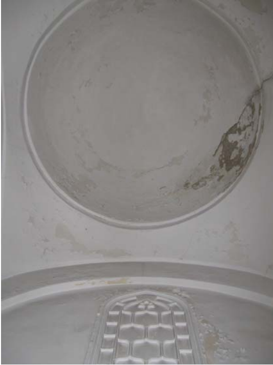
Şekil 5.117 Z-13 nolu odada sıvada kabarma, 2010
