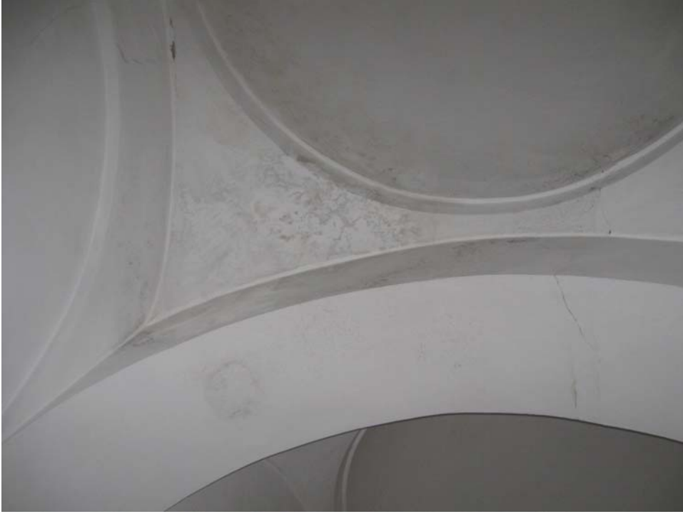
Şekil 5.106 Z-15 nolu odadaki çatlak, 2010
