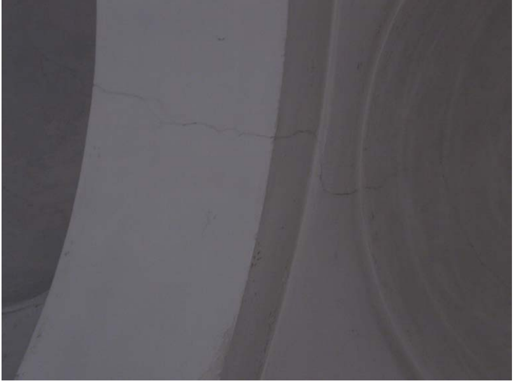
Şekil 5.103 Z-05 nolu mekandaki çatlak, 2010
