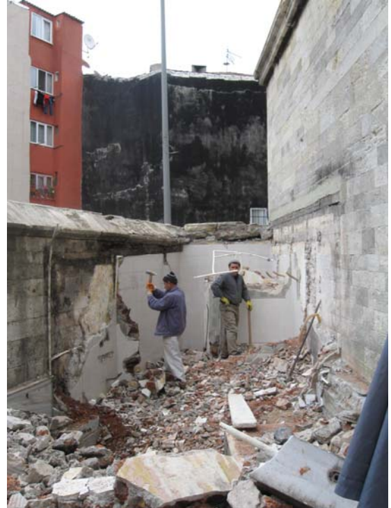
Şekil 7.12 Tuvalet grubunun yıkılması, 2010
