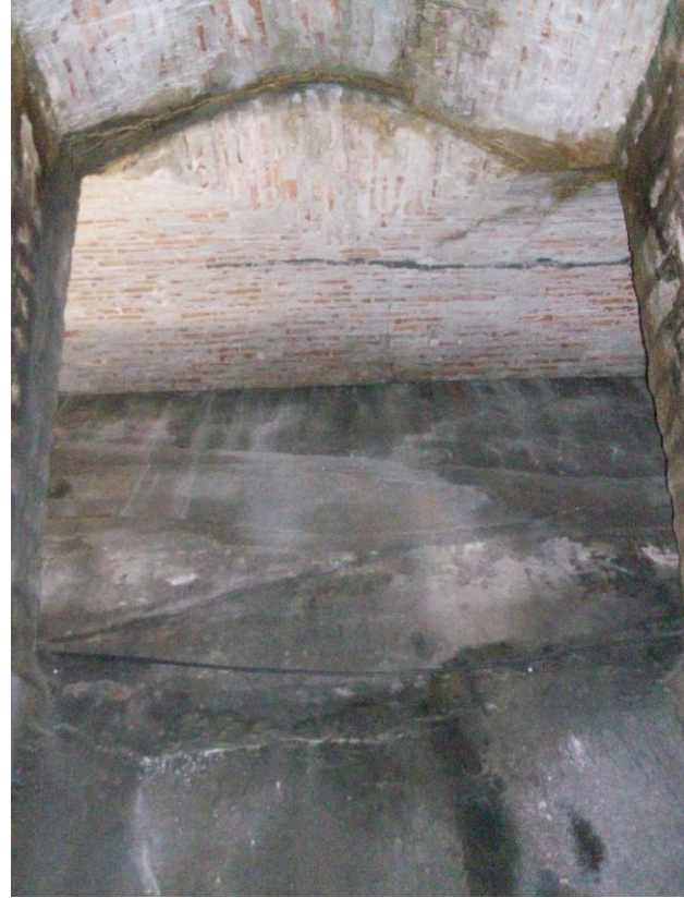
Şekil 5. 3 Batı kısmın tavanındaki H-I aksları arasında başlayan çatlak (2010)
