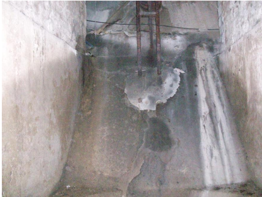
Şekil 5. 16 Güney duvarının iç yüzeyindeki kabuklanma (2010)
