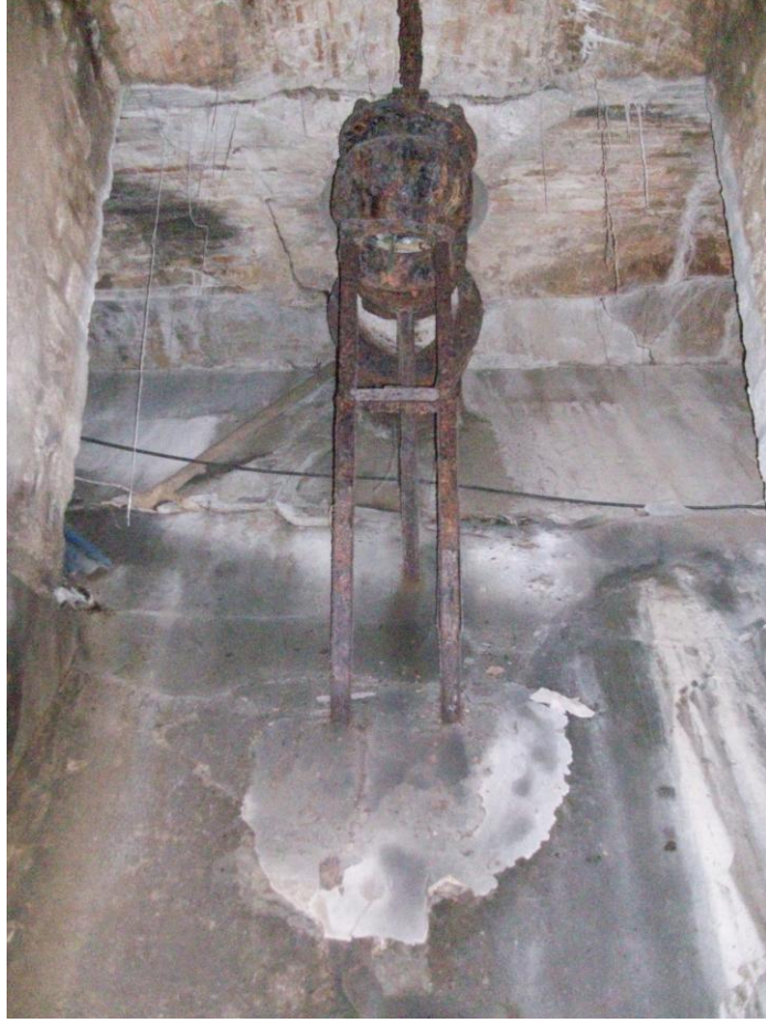
Şekil 4. 24 Güney duvarındaki su geliş borusu (2010)
