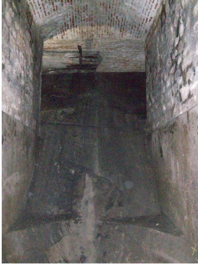
Şekil 5. 15 Güney duvarının sıvalı yüzeyindeki kararma (2010)
