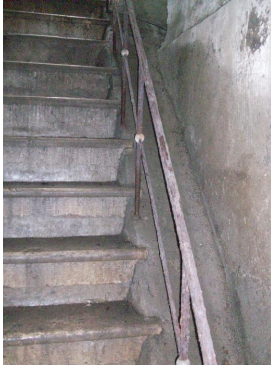
Şekil 4. 61 Eğimli dış duvara oturan metal korkuluk ayakları (2010)
