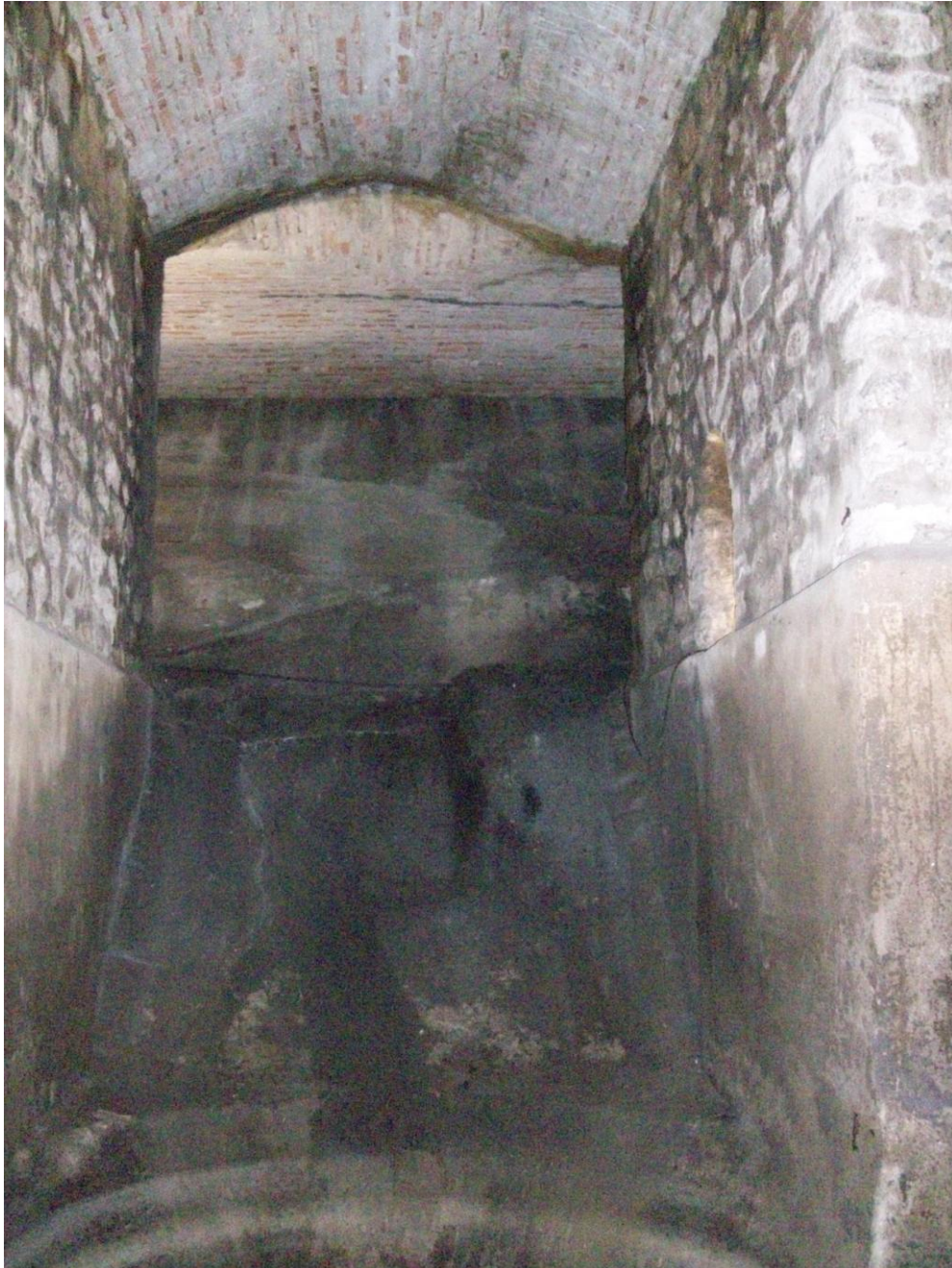
Şekil 5. 14 Batı duvarının sıvalı yüzeyindeki kararma (2010)
