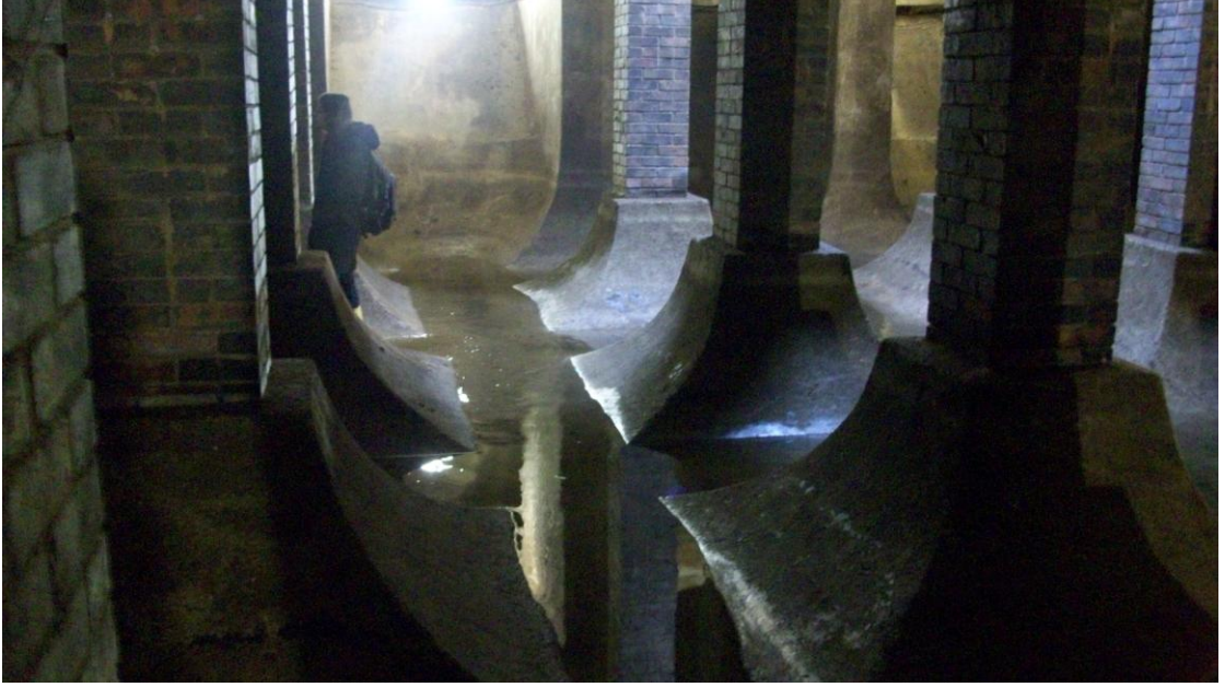
Şekil 4. 28 Zeminin en düşük kotta olduğu güneydoğu bölümdeki su birikintisi (2010) Zemindeki sıva, ara duvar ve dolu savak duvarlarında +2.50 m, ayaklarda +0.83 m kotuna kadar yükselmektedir (Şekil 4.29, 4.30, 4.31).
