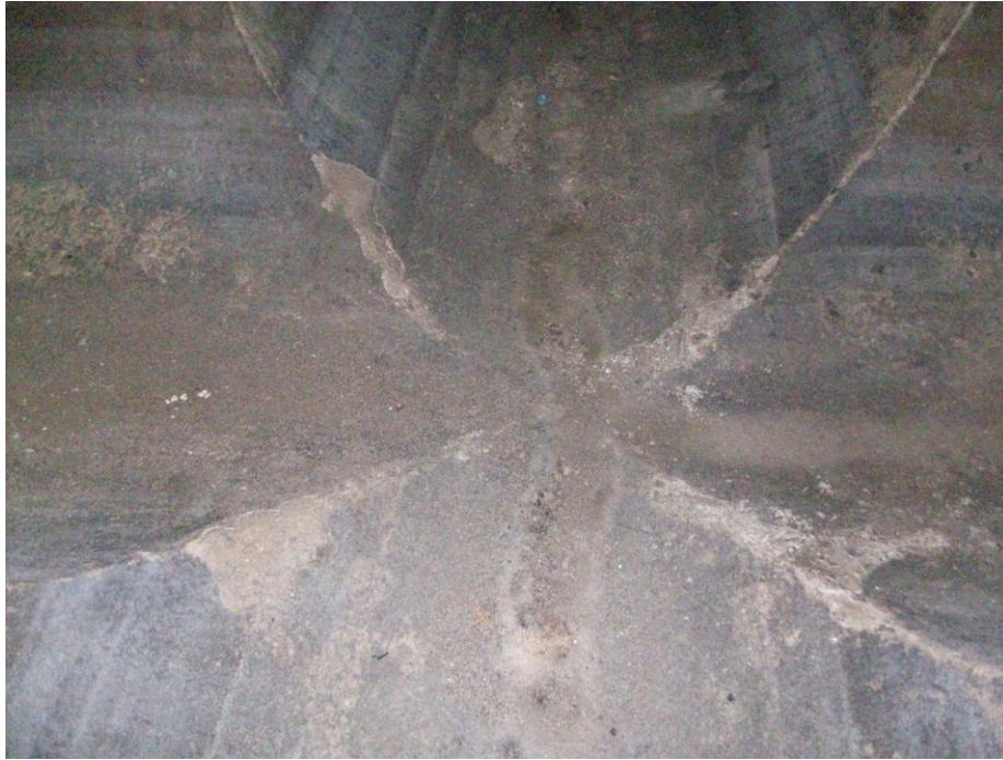
Şekil 5. 18 Zemindeki sıvalı yüzeyde malzeme kaybı (2010)
