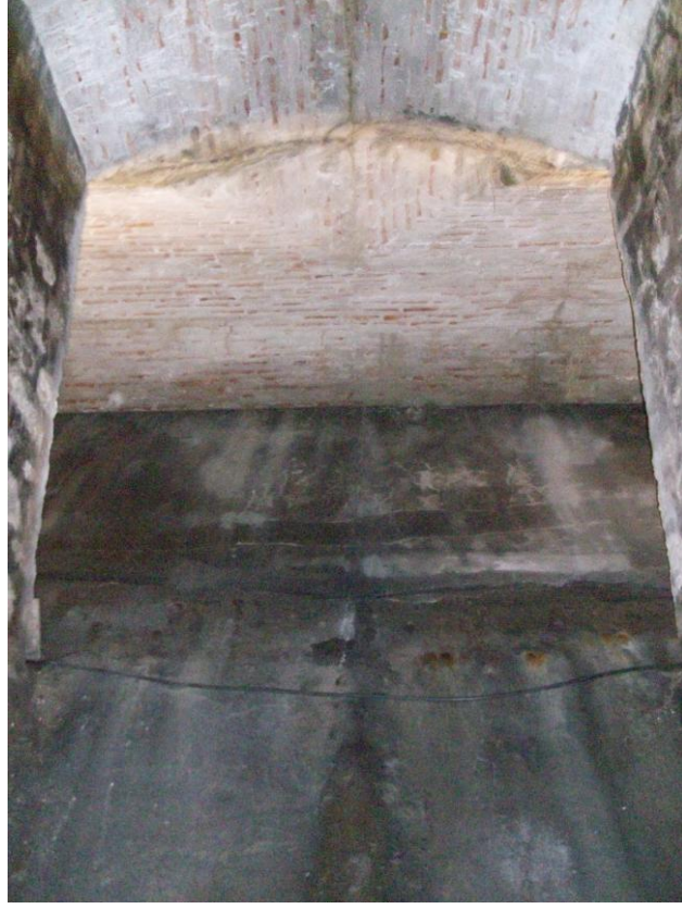
Şekil 5. 2 Batı kısmın tavanındaki tonoz arakesitlerinde görülen çatlak (2010)
