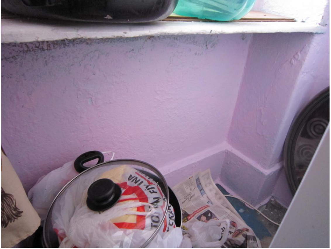
Şekil 4. 104 Ek bina mutfağındaki taş süpürgelik (2010)
