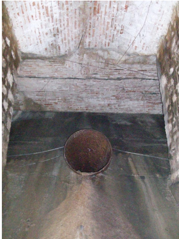
Şekil 4. 23 Kuzey duvarındaki su geliş borusu (2010)
