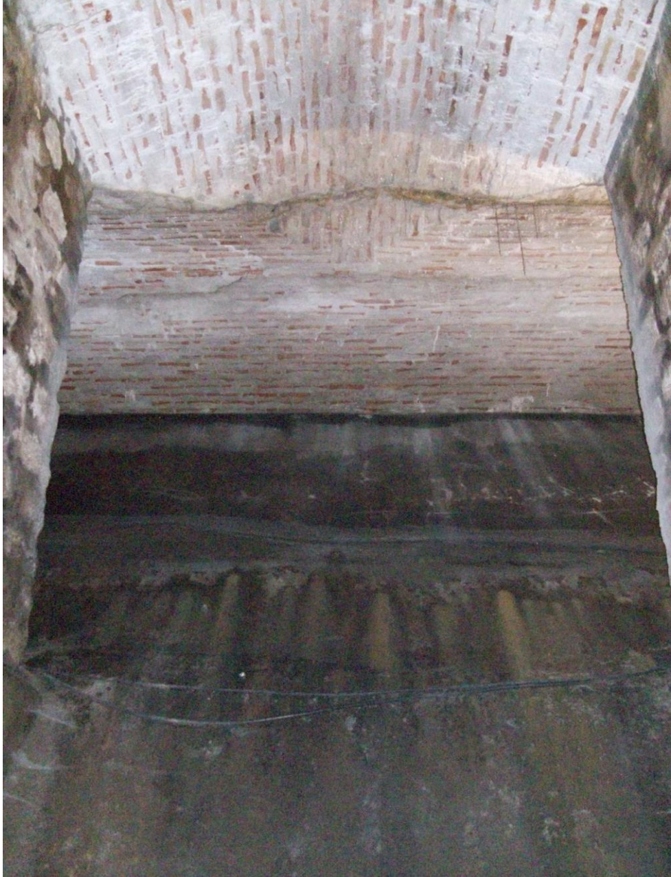
Şekil 5. 1 Batı tavanında F aksına kadar devam eden çatlak (2010)
