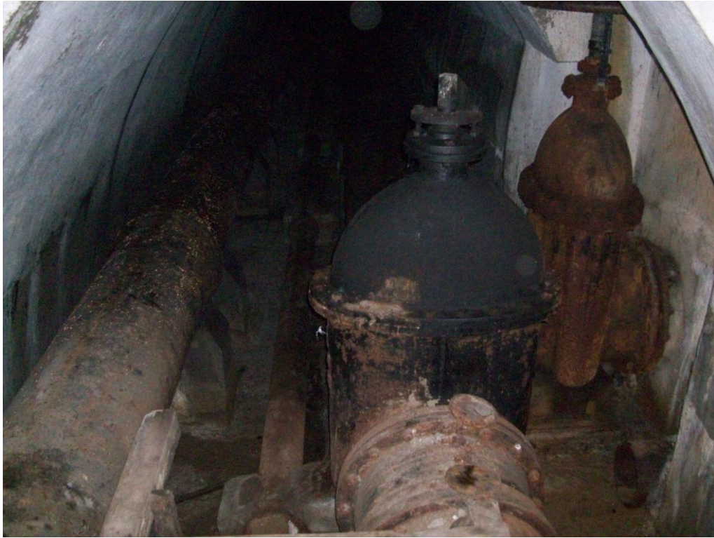
Şekil 3. 31 Vana mahallindeki vanaların görünüşü (2010)
