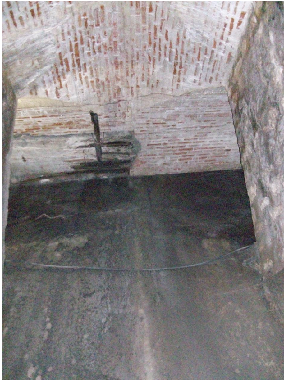
Şekil 5. 7 Tavandaki çökme ve ahşap destekler (2010)
