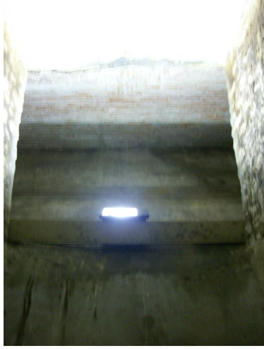
Şekil 5. 11 Batı duvarında G-H aksları arasındaki çatlak (2010)
