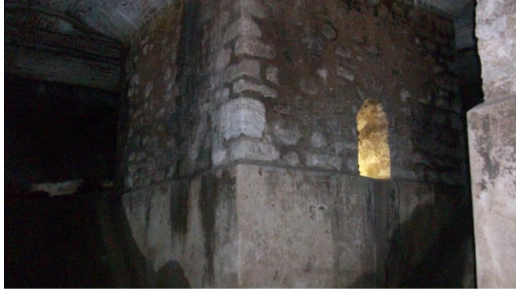
Şekil 4. 40 Dolu savak duvarı (2010)
