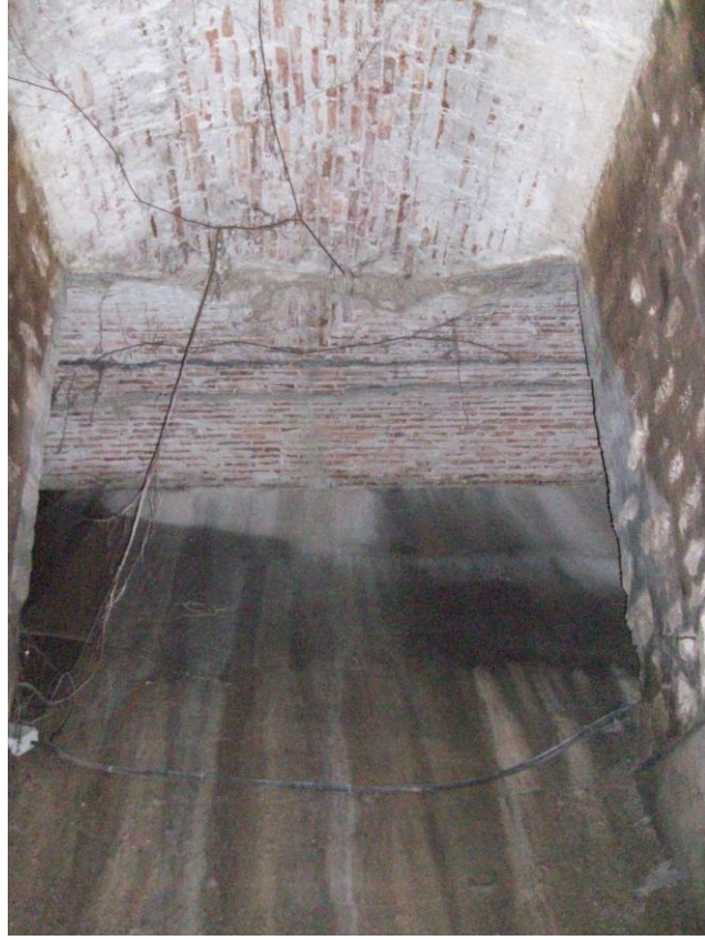
Şekil 5. 5 Kuzey duvarının tavanında 5-6 aksları arasında başlayan çatlak (2010)
