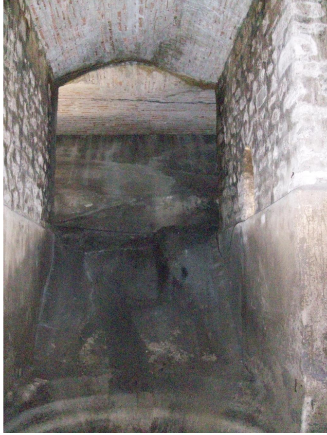
Şekil 4. 38 Kısmen kararmalar görülen batı dış duvarının iç yüzeyi (2010)
