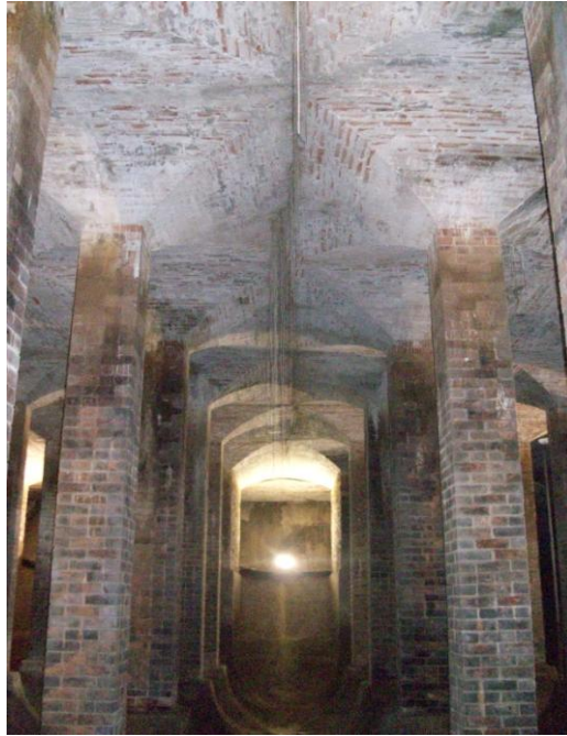
Şekil 5. 9 Tavanda görülen derz açılmaları ve sarkıtlar (2010)
