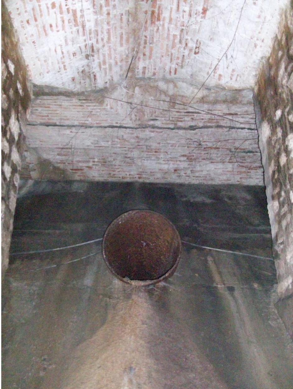
Şekil 5. 4 Batı kısmın tavanından kuzey ve doğu kenarlarına kadar süren çatlak (2010)
