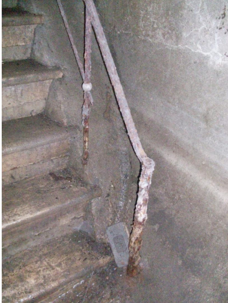
řekil 5. 19 Merdiven korkuluđunda korozyon (2010)
