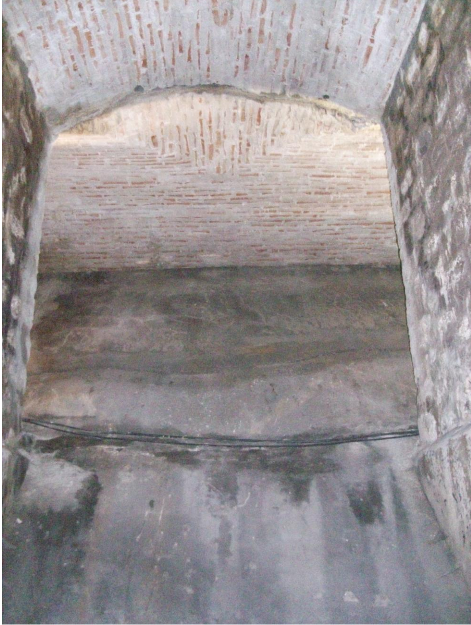
Şekil 5. 10 Batı duvarında B-I aksları arasındaki çatlak (2010)
