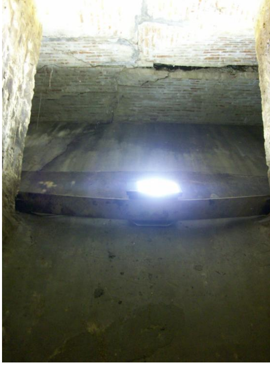
Şekil 5. 8 Tavanda çatlaklar ve 25 cm'yi bulan çökme (2010)
