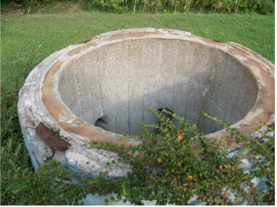
Şekil 5. 20 Havalandırma bacasında malzeme kaybı ve metal kenetlerin görünüşü (2010)
