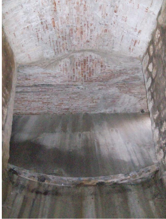
Şekil 5. 6 Kuzey duvarının tavanındaki ince çatlaklar (2010)
