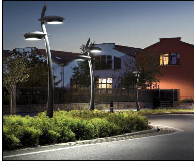
Şekil 3.6 Yol aydınlatma elemanı [5]
