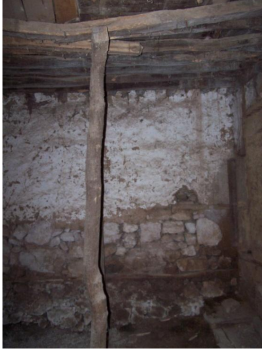
Şekil 6.27 Döşemedeki sehimden dolayı konan muhdes dikme
