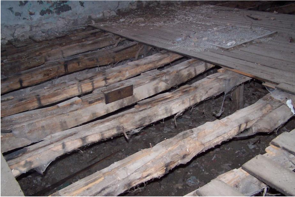
Şekil 2.9 Kilisenin döşemesindeki hasarlar
