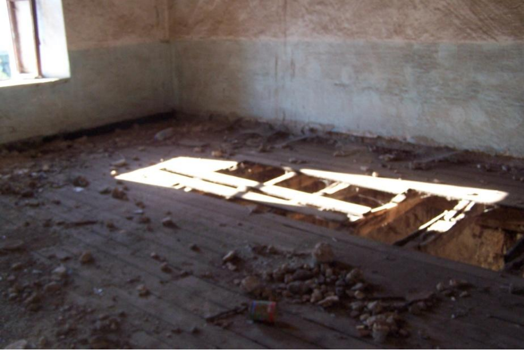
Şekil 2.8 Kilisenin döşemesindeki hasarlar
