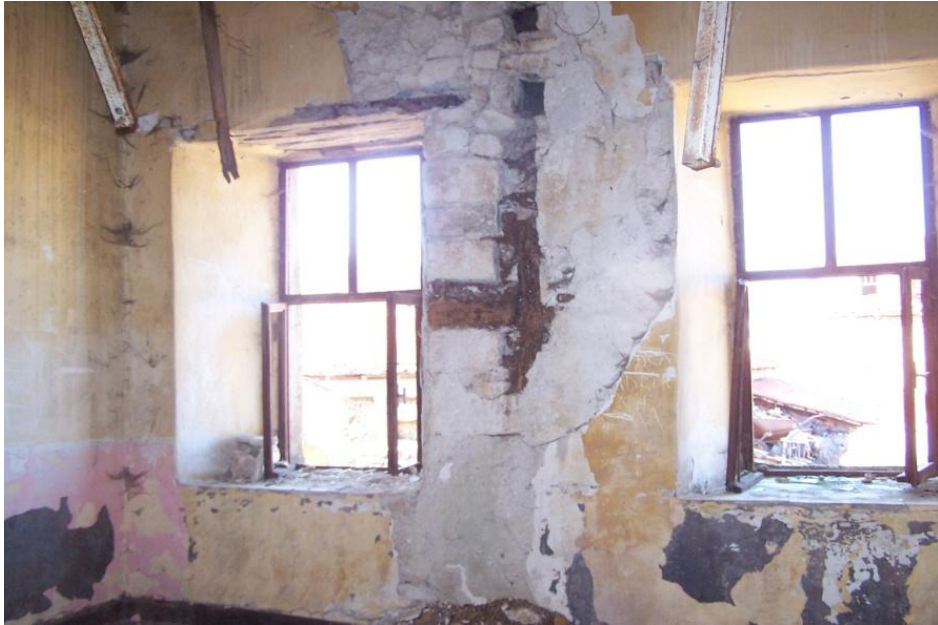
Şekil 2.7 Kilisenin duvar ve pencerelerindeki hasarlar
