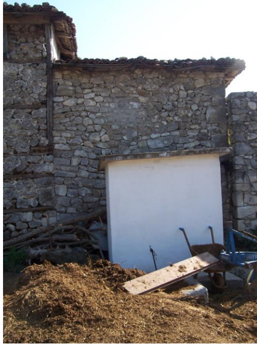
Şekil 6.160 Muhdes ek yapı
