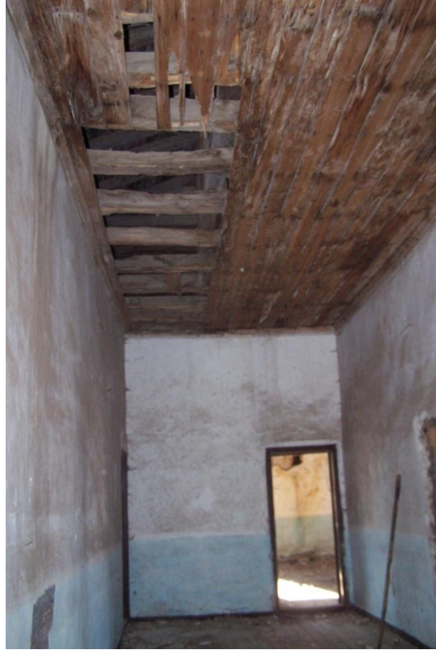
Şekil 2.6 Kilisenin tavan ve duvarlarındaki hasarlar
