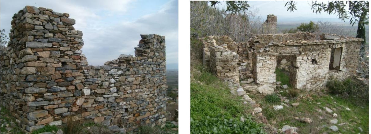
Şekil 5.39 Kısmen yıkılmış, harçları ve sıvaları dökülmüş, yapı duvarları
