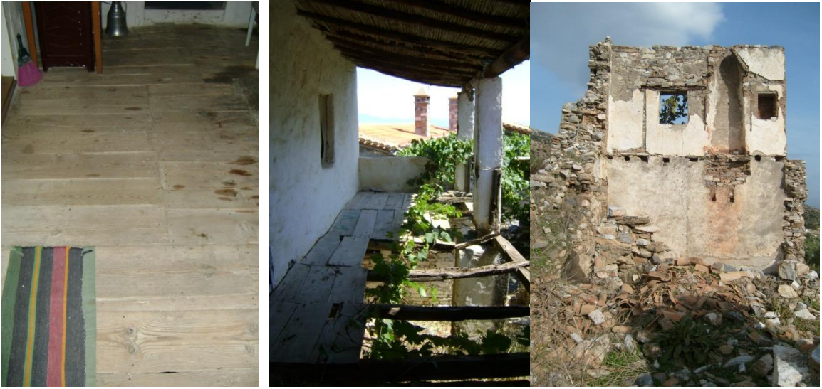
Şekil 5.38 Aşınmış ahşap kaplama, malzeme kaybına uğramış ahşap kaplama ve ahşap döşeme kirişlerinin izleri
