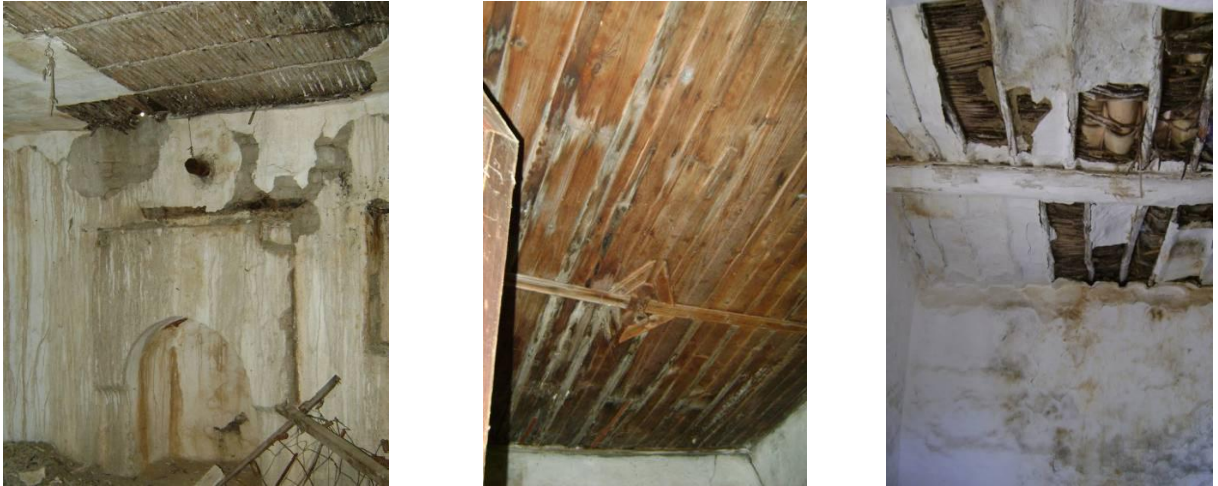
Şekil 5.27 Bağdadi sıvası dökülmüş tavan, ahşap pasalı tavan ve sıvası dökülen ahşap çatı elemanları
