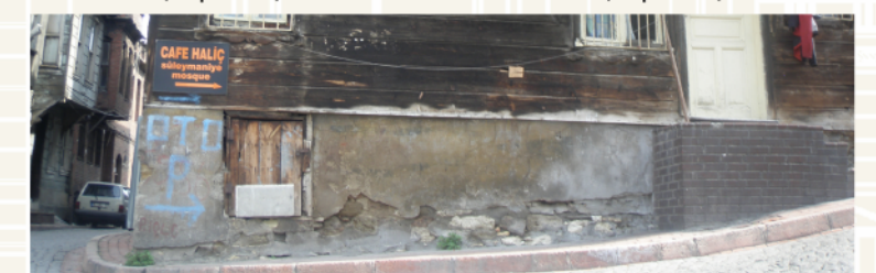
subasmanda taş üzeri kaba sıva örneği (bozulmalar gözlenmiştir) (4. parsel)
