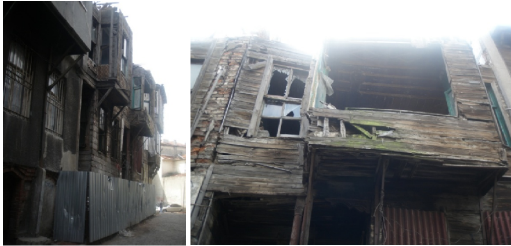
Şekil 4.18 ve Şekil 4.19 Tarihi Yarımada’da Seçilen Bölgede Bulunan Metruk Bina Örnekleri
