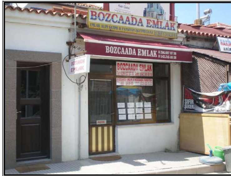
Şekil 5. 11 Ticaret fonksiyonlu yapıların cephelerinde yapılan müdahaleler. (Envanter no:B-K-4, Ek IV, s.389)
