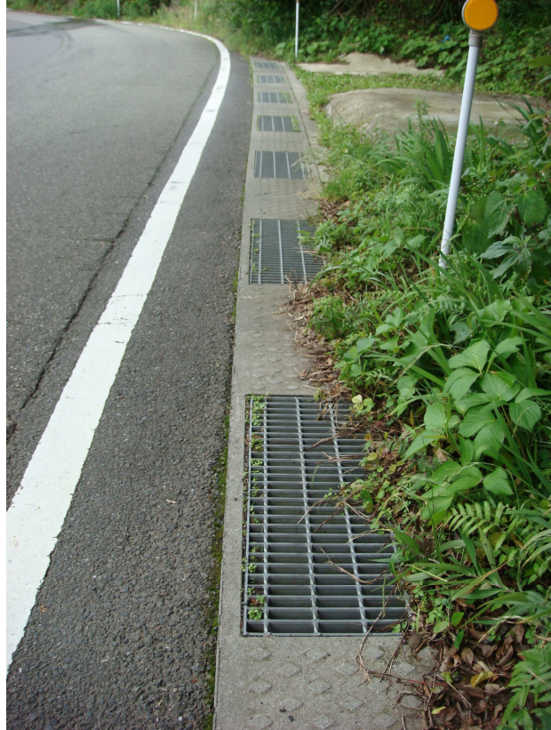
Şekil 3.21 Kanala karışan yağmur suyu ızgaraları
