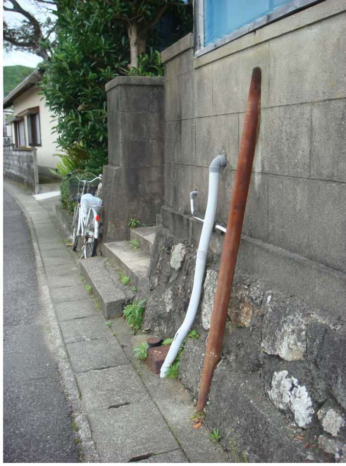
Şekil 3.22 Evlerin kirli sularının, altyapı sistemi olmadığı için belediye kanallarına akıtılması
