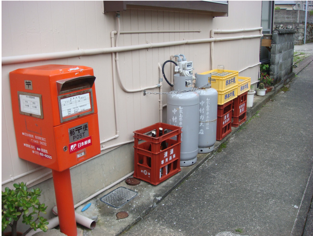
Şekil 3.23 Altyapı sistemi olmadığı için gaz ihtiyacının dışarıdan sağlanması
