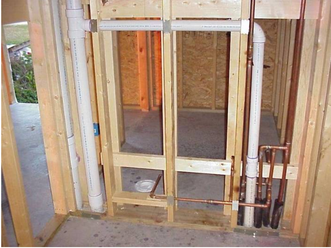
Şekil 4.5 İç bölme içerisinden geçirilen tesisat boruları (Swamidas, 2005b)
