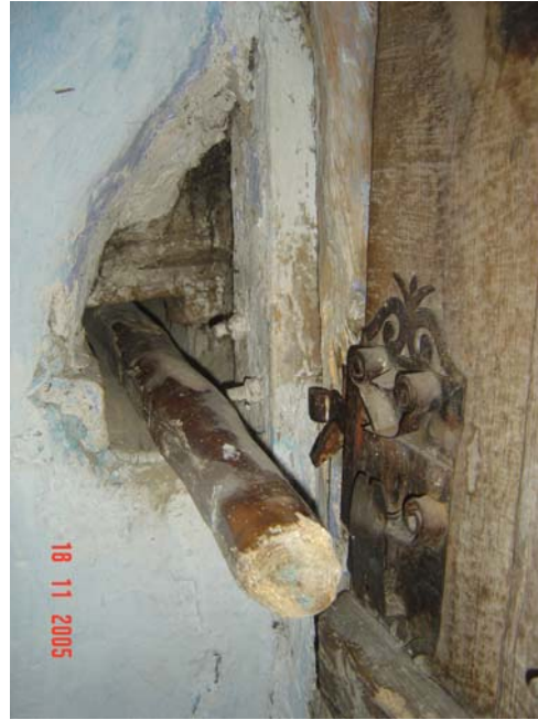
Şekil 5.8 1. Kat giriş kapısı ve kilit düzeneği (105).
