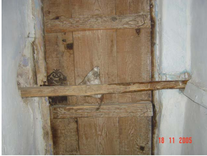
Şekil 5.7 1. Kat giriş kapısı ve kilit düzeneği (105).
