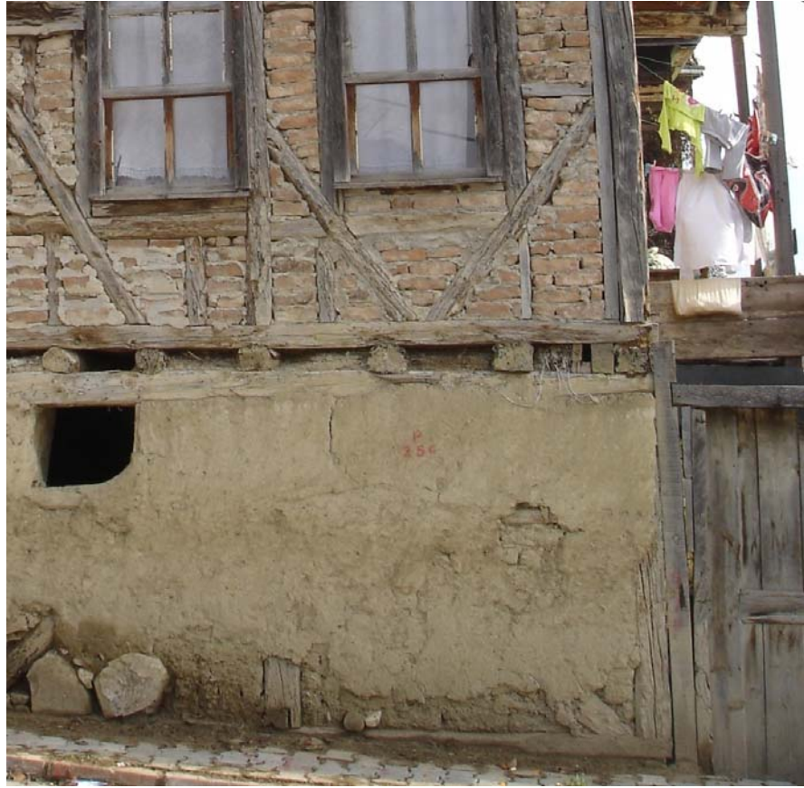
Şekil 4.9 Kadir Sayın evi, döşeme kirişlerinin giriş cephesindeki durumu, 2007.
