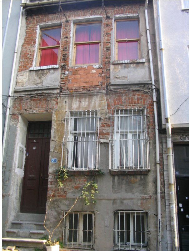
Fotoğraf 8.2 Cumbası yıkılmış ve süslemeleri sökülmüş yapı, Ada 617-Parsel 20
