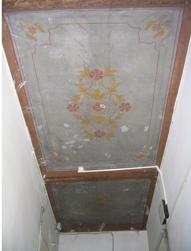
Fotoğraf 7.13 Giriş holü orijinal tavan boyası ( Ada 621, Parsel 16-17)
