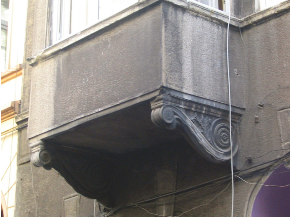
Fotoğraf 6.17 Taş cumba konsolu. Ada 609-Parsel 21
