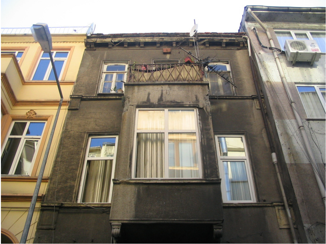
Fotoğraf 8.10 Cephesi kirlenmiş ve tahrip olmuş yapı, Ada 609-Parsel 21
