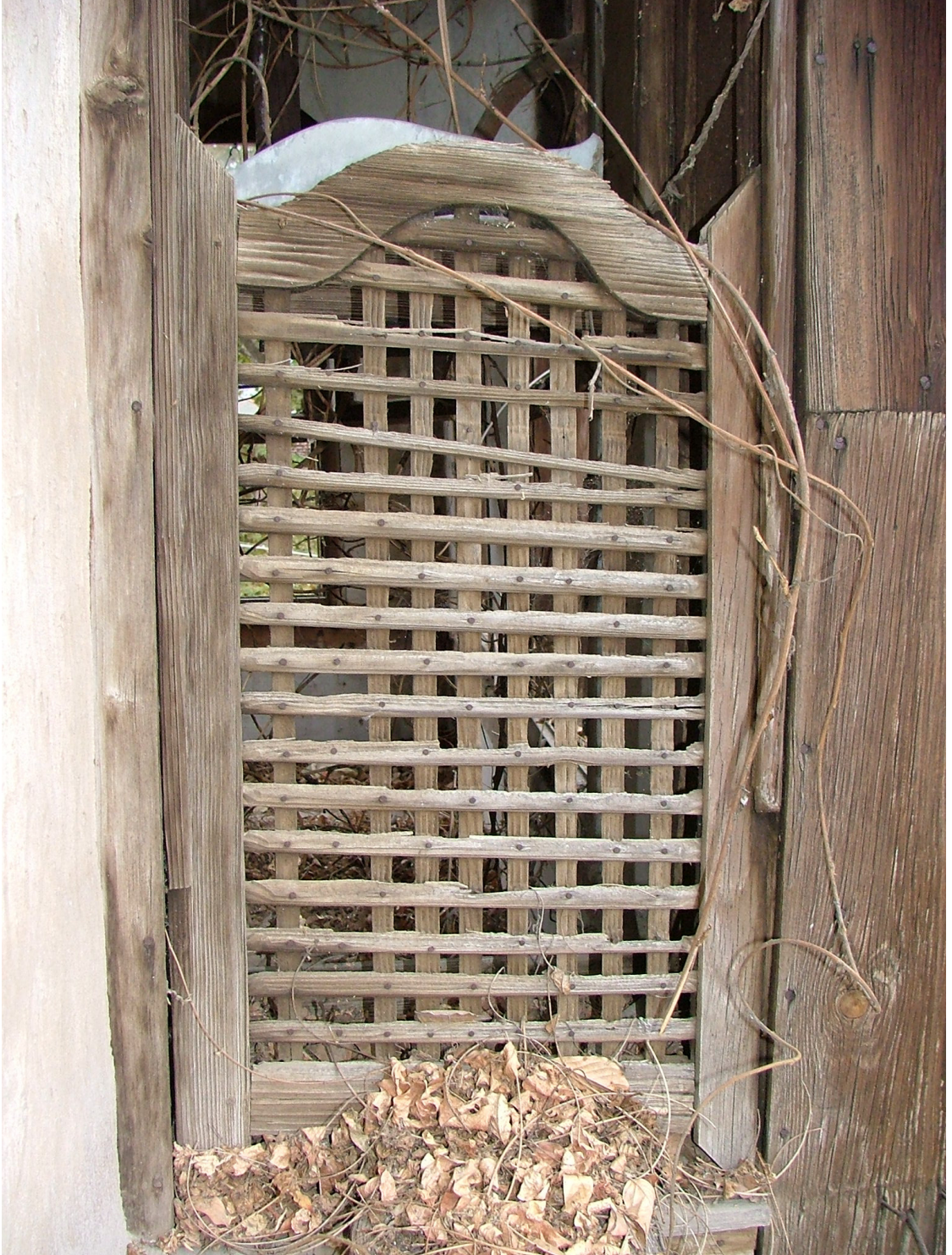
Resim 3.8 Yapı cephesinde tek kalmış ahşap kafes
