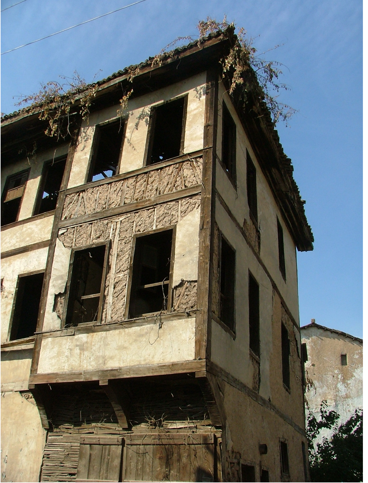
Resim 3.5 Cebecioğlu Konağı doğu cephesindeki sıva bozulmaları
