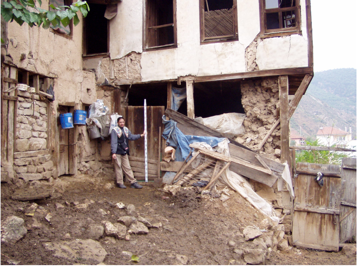
Resim 3.20 Kuzey ve gney cephesindeki deformatsyon
