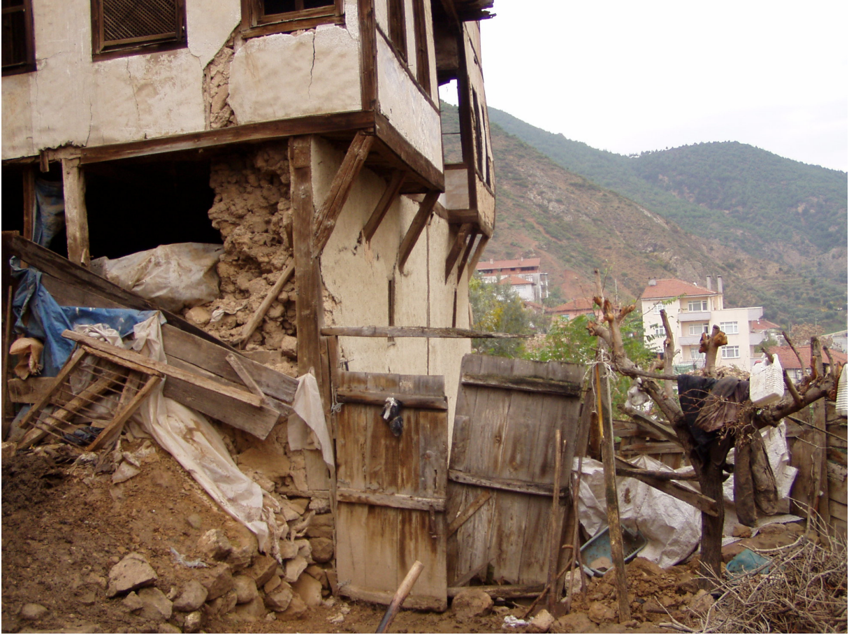
Resim 3.17 Yapının doğu cephesindeki yıkılma
