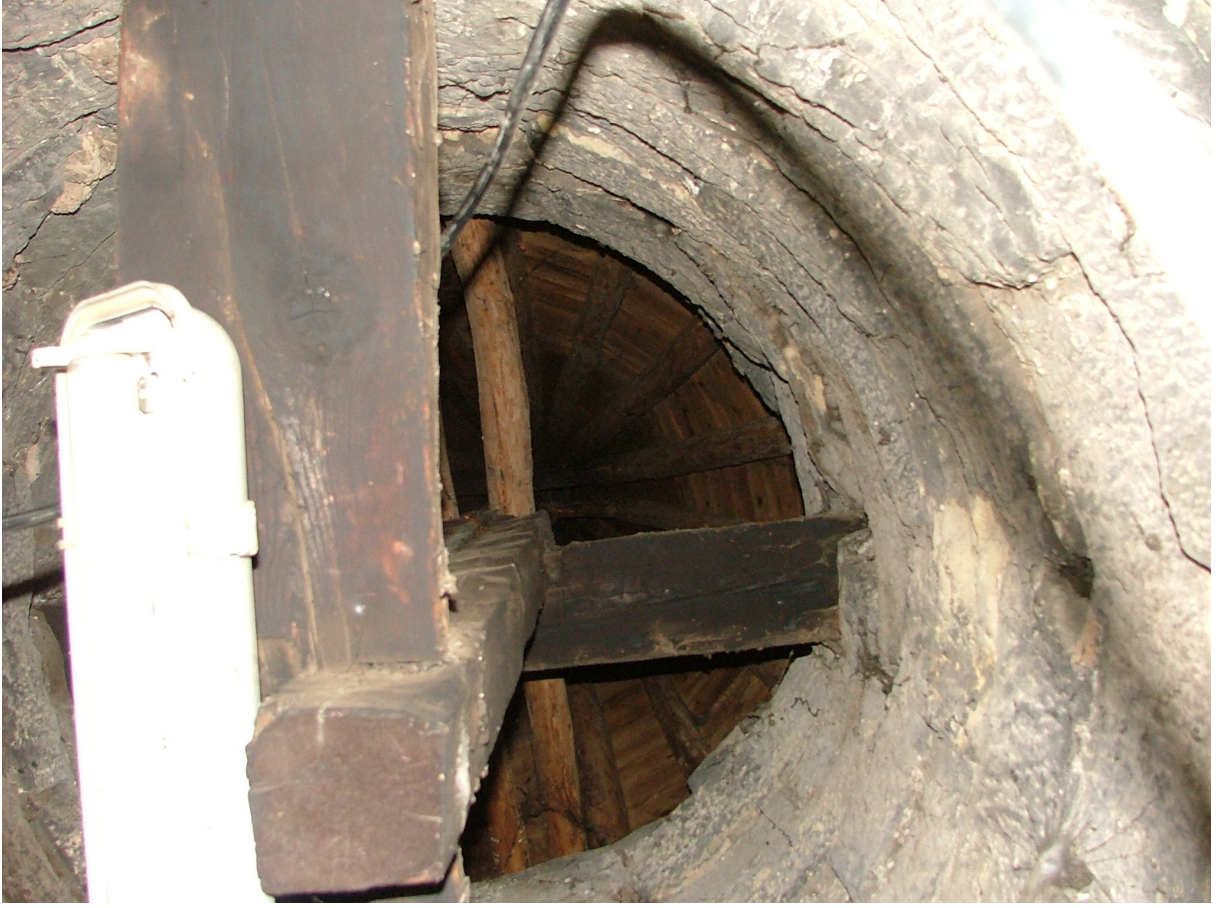
Resim 3.46 Rüstem Paşa Camii minaresinde havada kalan seren direği
