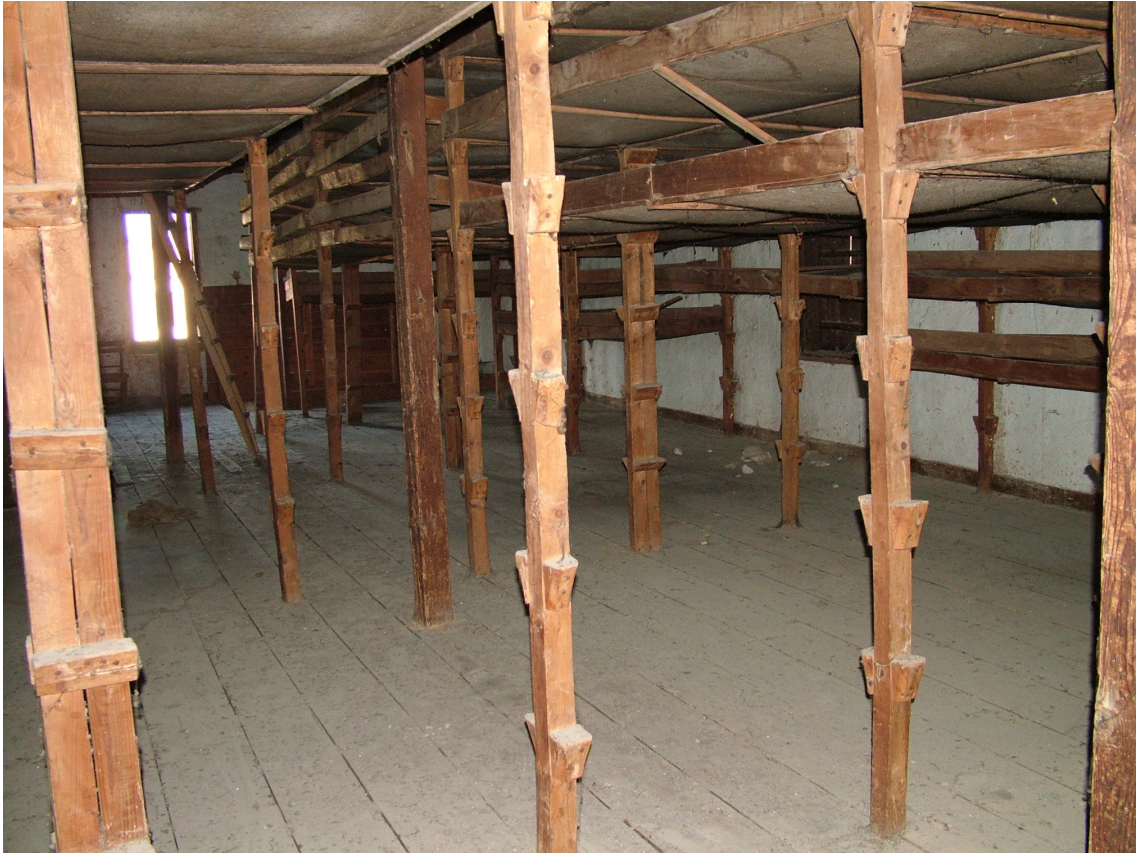
Resim 3.25 Zemin katta bulunan ahşap dikmeler
