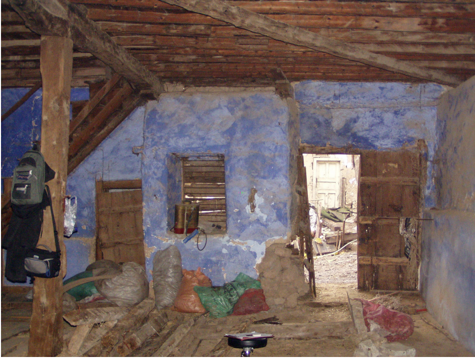
Resim 3.15 Tavan kaplaması yapılmamıř mekanlar (zemin kat).
