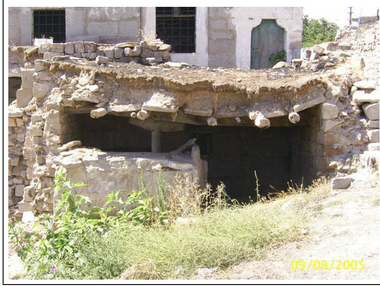
Resim 4.47 Envanter No: 12, Yıkılmış yapıdan toprak dam örtüsü ve duvar detayı, 2005
