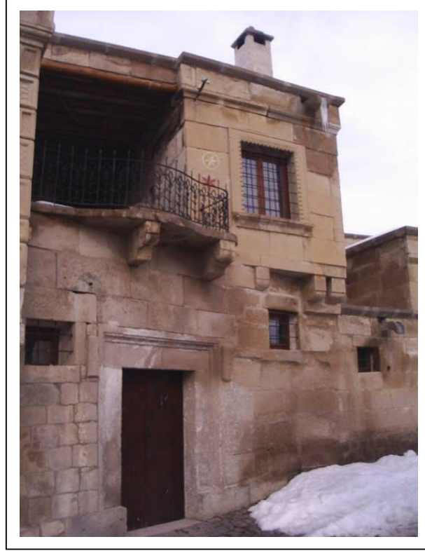
Resim 4.69 Envanter No:06, Kapı No:32, Balkon çıkması ve gönye çıkma, 2004
