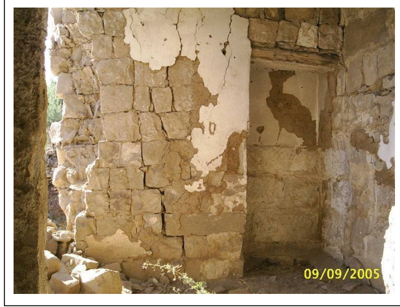
Resim 4.43 Envanter No:13, Kapı No:78, Yıkılmış oda duvarı ve yüklük, 2005
