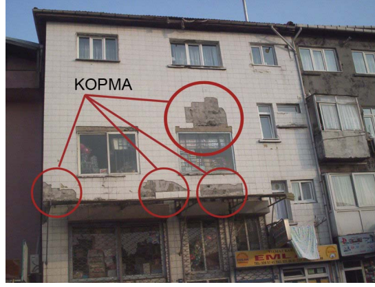
Şekil 3.7 Isı değişimleriyle betondaki daralmanın dış cephe ürününde basınç oluşturması ve ürün-bağlayıcı arasındaki farklı gerilmelerle cephe ürününde kopma gözlenmesi
