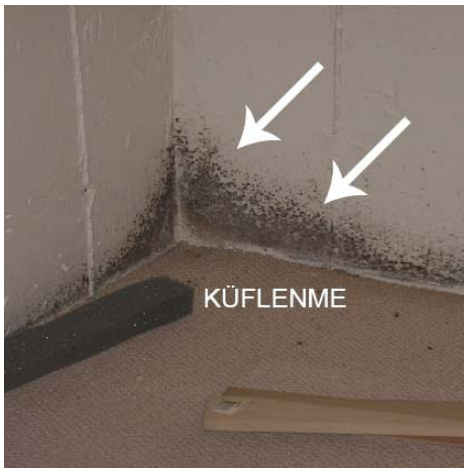
Şekil 3.21 Duvarda gözlenen küflenme sorunu [11]
