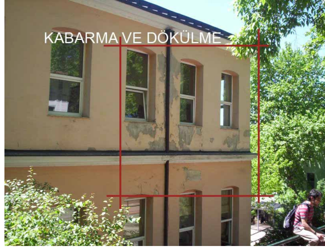
Şekil 3.10 Yapının dış cephesinde gözlenen şişme ve büzülmeyle, dış cephe boyasının kabarması ve dökülmesi
