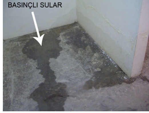
Şekil 3.49 Zemine oturan bodrum kat döşemesinden basınçlı suların içeri sızması
