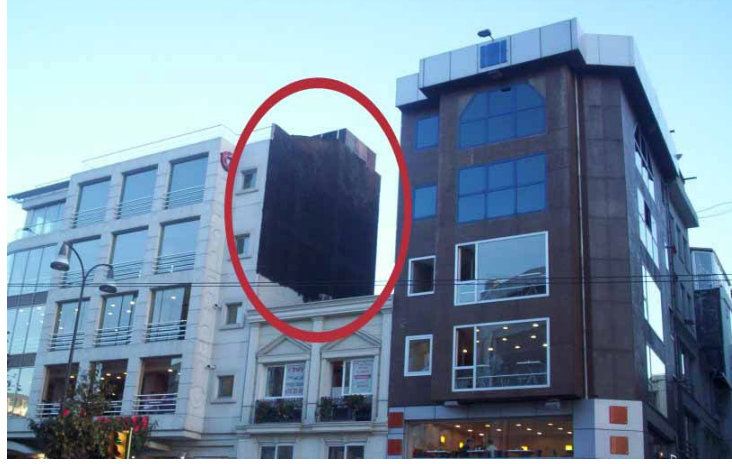
Şekil 3.62 Yapının su ve ısı etkenlerinden en çok etkilenen cephesinde yapılan, hatalı yalıtım uygulaması
