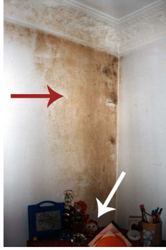
Şekil 3.42 Tasarım aşamasında su ve ısı yalıtımlarına yönelik çözümlerin oluşturulmaması nedeniyle, kullanılan bir konutun betonarme yapı elemanlarında sorun ortaya çıkması [16]
