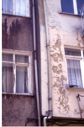
Şekil 3.57 Bir konut cephesindeki bakım eksikliği
