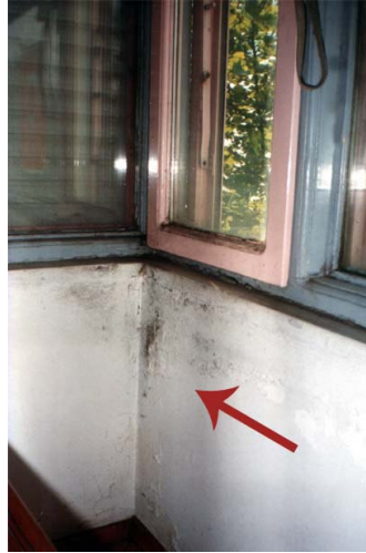
Şekil 3.46 Tasarım aşamasında su ve ısı yalıtımlarına yönelik çözümlerin hatalı oluşturulmaması nedeniyle, kullanılan bir konutun parasetinde sorun ortaya çıkması [16]
