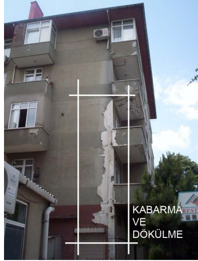
Şekil 3.34 Su ve ısı etkenlerinin dış cephe kaplaması ürün özelliklerinin bozulması ve ürünün servis ömrünü kısılması
