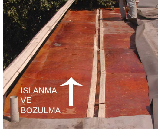
Şekil 3.32 Su etkeniyle ısı yalıtım ürününün bozulması ve ürünün servis ömrünün kısalması [16]
