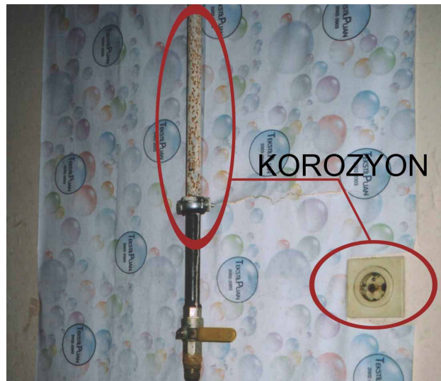
Şekil 3.24 Mutfak hacmindeki metal borularda ve elektrik prizinde gözlenen korozyon sorunu
