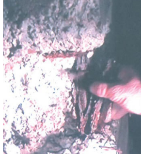
Şekil 3.36 Bodrum kat düşey donatılarının paslanması nedeniyle elle dağılabilmesi [18]
