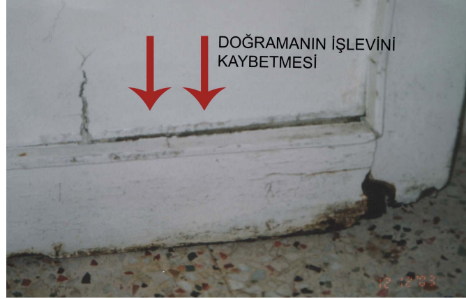
Şekil 3.12 Su etkeniyle şişerek çatlamış ve koparak işlevini kaybetmiş ahşap bir ıslak hacim kapısı
