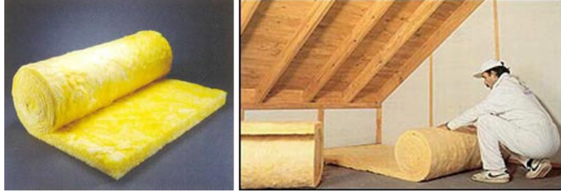
Şekil 4.33 Isıtılmayan bir çatı arasında cam yünü ısı yalıtım ürününün döşemeye serilmesi (İZOTOPRAKa)
