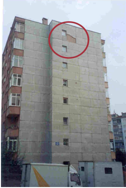
Şekil 3.53 Yapı cephesinde boyut kararlılığı olmayan levhaların kullanılması sonucunda farklı gerilmelerin levhalar tarafından karşılanamaması ve cephede dökülmelerin gözlenmesi [24]
