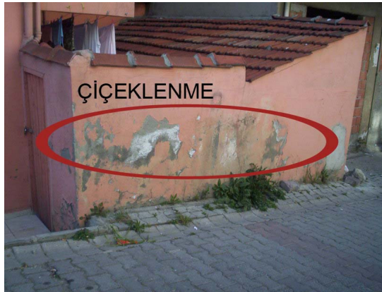
Şekil 3.15 Yapı cephesinde çiçeklenme gözlenmesi
