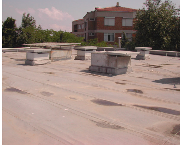
Şekil 3.59 Çatının kullanım aşamasında çatıda oluşan su sorunu [16]
