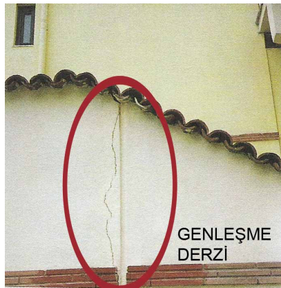
Şekil 3.8 Harçla doldurulmuş genleşme derzi nedeniyle gerilmeleri karşılayamayan duvarda çatlak oluşumu (Baytop, 2006)
