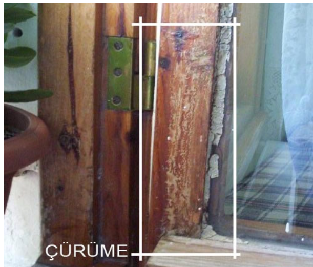
Şekil 3.28 Bir konutun ahşap doğramasındaki çürüme sorunu
