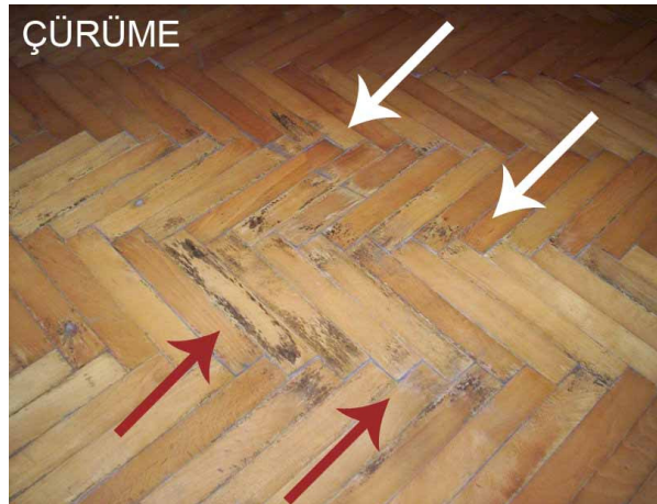
Şekil 3.30 Su ve ısı etkenlerinin ahşap döşeme kaplamasında oluşturduğu çürüme sorunu
