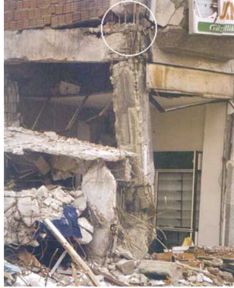
Şekil 3.35 17 Ağustos 1999 Kocaeli Depremi'nde donatıların paslanarak kesitlerinin zayıflaması ve zamanla çürümesi sonucu yapıda ağır hasarların oluşması [18]
