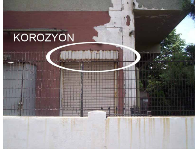
Şekil 3.25 Bir servis girişinin saçağında gözlenen korozyon sorunu
