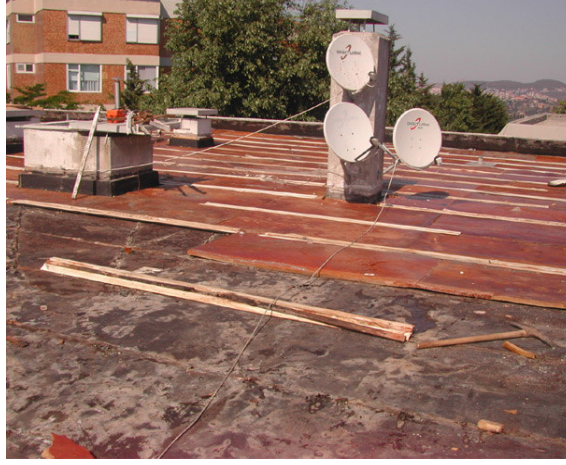
Şekil 3.60 Suyun çatı örtüsünün altına geçmesi sonucu ıslanan ısı yalıtım ürünleri [16]
