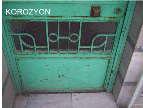
Şekil 3.26 Bir konutun demir giriş kapısında gözlenen korozyon sorunu
