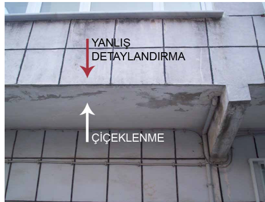
Şekil 3.48 Konsol döşemede hatalı detaylandırma sonucu oluşan çiçeklenme sorunu
