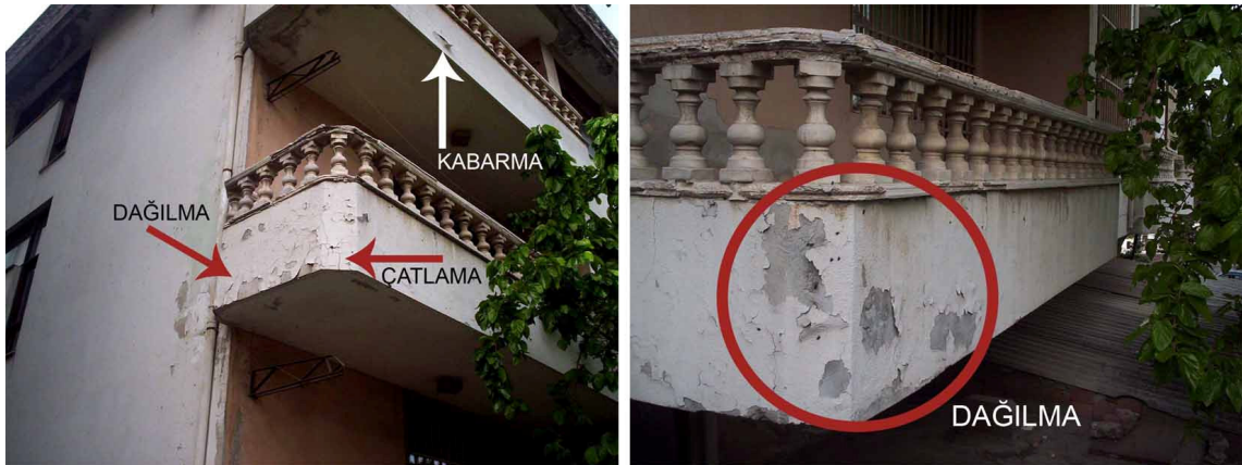
Şekil 3.20 Yapı cephesinde kabarma, çatlama ve dağılma sorunlarının gözlenmesi
