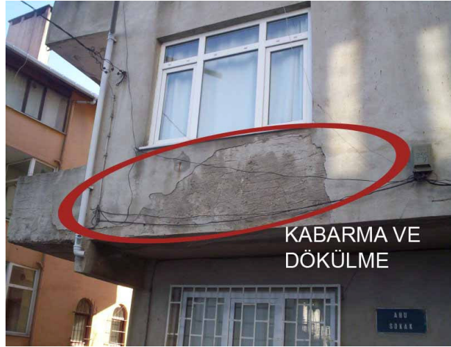
Şekil 3.9 Yapının dış cephesinde gözlenen şişme ve büzülmeyle, ince sıvanın kabarması ve dökülmesi
