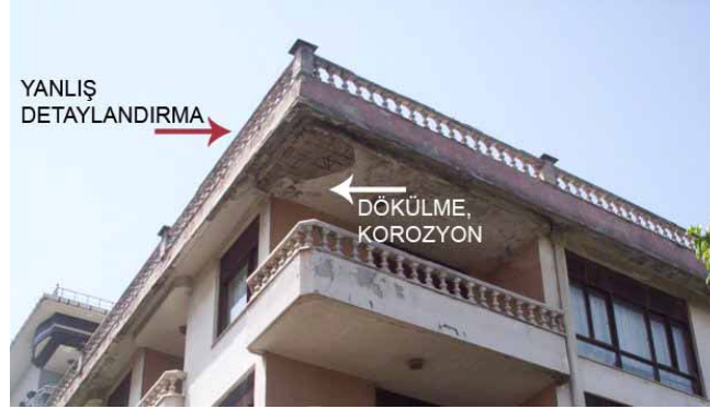
Şekil 3.47 Parapette hatalı detaylandırma sonucu oluşan dökülme ve korozyon sorunları
