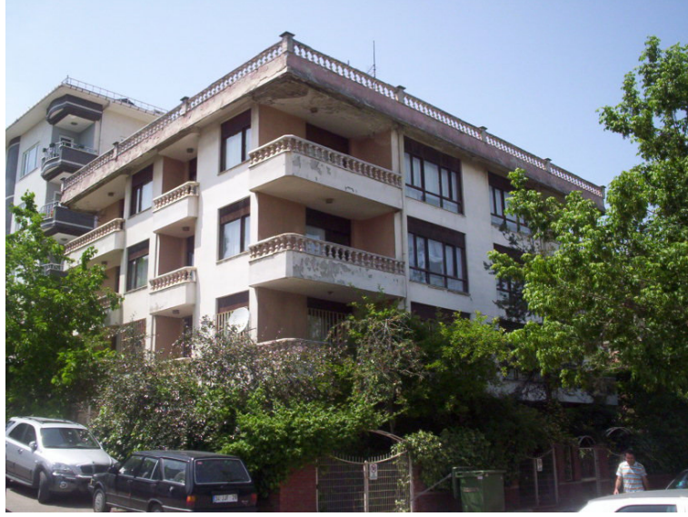
Şekil 3.38 Su ve ısı etkenlerinin oluşturduđu sorunlar nedeniyle bakımsız bir betonarme yapı
