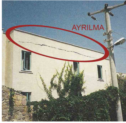
Şekil 3.5 Çatı parapetindeki tuğla ve betonarmenin genleşme katsayılarındaki farklılık nedeniyle birleşim yerlerinden ayrılması (Baytop, 2006)
