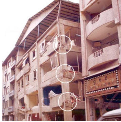
Şekil 3.37 17 Ağustos 1999 Kocaeli Depremi'nde içinden pvc yağmur iniş borularının geçtiği kolonlarda donatıların paslanarak kesitlerinin zayıflaması ve zamanla çürümesi sonucu yapıda ağır hasarların oluşması [18]
