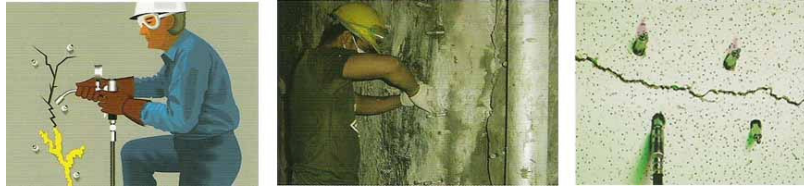
Şekil 4.22 Mevcut bir yapıda su etkisiyle oluşmuş çatlağın enjeksiyon yöntemiyle katkı eklenerek kapatılması (KOSTER Waterproofing Systems)
