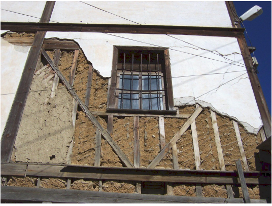
Foto Ek 1.212 Şamlılar Çeltik Fabrikası, güneybatı cephesi, birinci modül birinci kat duvarı, Ekim 2003
