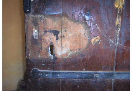
Foto Ek 1.225 Şamlılar Çeltik Fabrikası, Z-01 giriş holüne açılan kapının sökülmüş özgün demir kilidinin izi, Ekim 2003
