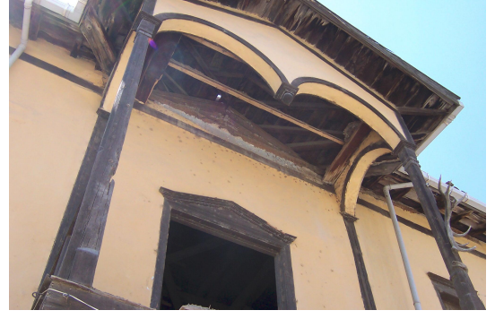
Foto Ek 1.191 Şamlılar Çeltik Fabrikası, kuzeydoğu cephesi, balkonun çökmüş tavanı, Temmuz 2005
