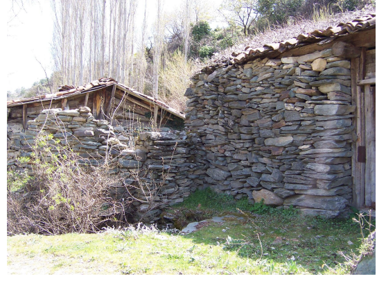
Foto Ek 1.55 Gazidere Tabaklısı Köyü, Ahmet Eskici Değirmeni önündeki Hüseyin Öztürk Değirmeni'ne ait duvar yıkıntısı, Nisan 2004
