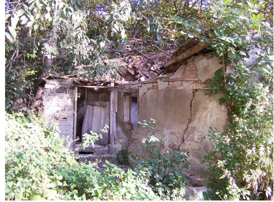
Foto Ek 1.50 Boyabat, Şamlıların Değirmeni, ahır yapısının kuzey cephesi ve bu cepheye sonradan eklenmiş tuvalet yapısı, Eylül 2004
