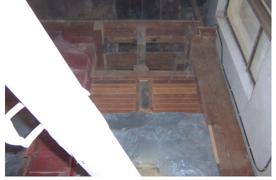
Foto Ek 1.245 Şamlılar Çeltik Fabrikası, Z-04 Üretim 1 mahallindeki havalı parlatma taşını birinci kattaki ambara bağlayan kanal ve ambarın ön yüzeyi, Temmuz 2005
