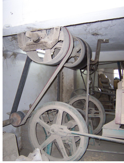
Foto Ek 1.234 Şamlılar Çeltik Fabrikası, Z-04 Üretim 1 mahalli ve makineleri mile bağlayan kasnaklar, Nisan 2004.
