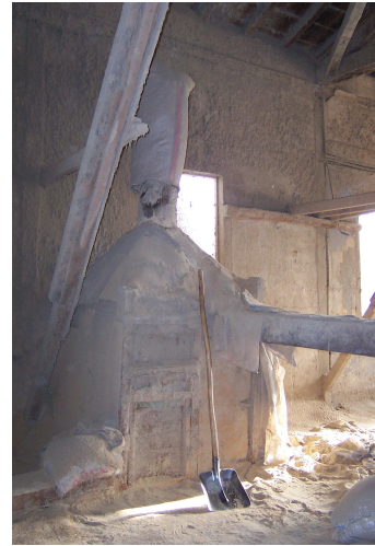
Foto Ek 1.291 Şamlılar Çeltik Fabrikası, 2-01 mahalli, aspiratör görünüm, Nisan 2004
