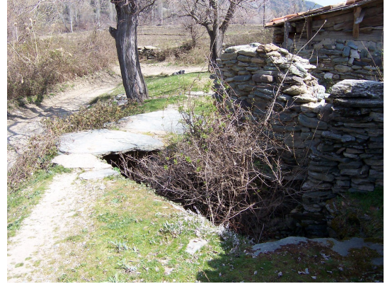
Foto Ek 1.56 Gazidere Tabaklısı Köyü, Ahmet Eskici Değirmeni önündeki Hüseyin Öztürk Değirmeni'ne ait duvar yıkıntısı ve domuzluktan çıkan su yolu, Nisan 2004
