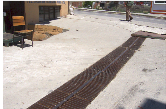
Foto Ek 1.175 Şamlılar Çeltik Fabrikası güneydoğu cephesi önünde bulunan ve arka bağlanan su toplama kanalı, Temmuz 2005
