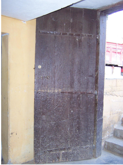
Foto Ek 1.223 Şamlılar Çeltik Fabrikası, güneydoğu cephesinden zemin kata açılan kapı kanadı dış yüzeyi, Ekim 2003
