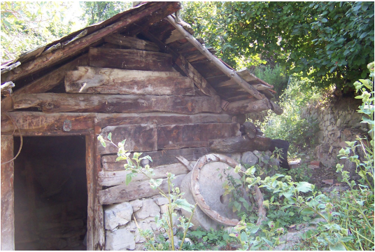
Foto Ek 1.101 Ekinören Köyü, Koca Mehmet'in Değirmeni (Şerafettin Gökçe Değirmeni), güneydoğu cephesi, Temmuz 2005
