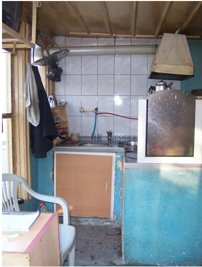
Foto Ek 1.278 Şamlılar Çeltik Fabrikası, 1-06 Kahvehane, sonradan eklenmiş mutfak tezgahı, Nisan 2004
