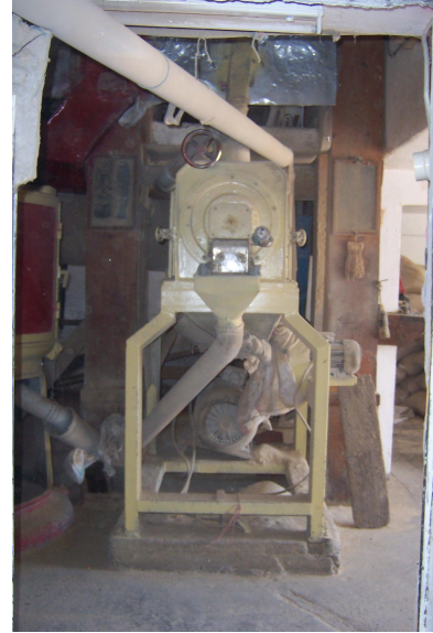
Foto Ek 1.246 Şamlılar Çeltik Fabrikası, Z-04 Üretim 1 mahallindeki parlatma taşı, ortaya çıkan kepeği toplayan kanal, Temmuz 2005
