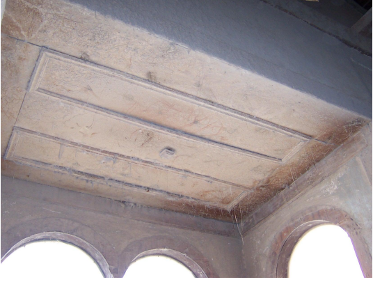
Foto Ek 1.287 Şamlılar Çeltik Fabrikası, 2-01 Üretim 3 mahalli, güneydoğu yönünde çıkmanın pasalı ahşap tavan kaplaması, Nisan 2004
