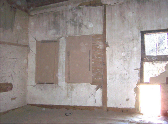
Foto Ek 1.292 Şamlılar Çeltik Fabrikası, 2-01 mahalli, kuzeydoğu cephesinde beşinci ve altıncı modüllerdeki pencereler iç görünüşü, Nisan 2004
