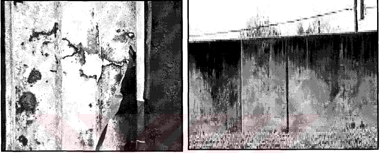
Şekil 4.120 Gürültü engellerinin malzemelerinin bozulması (FHWA, 2000; Jensen vd., 2002)
